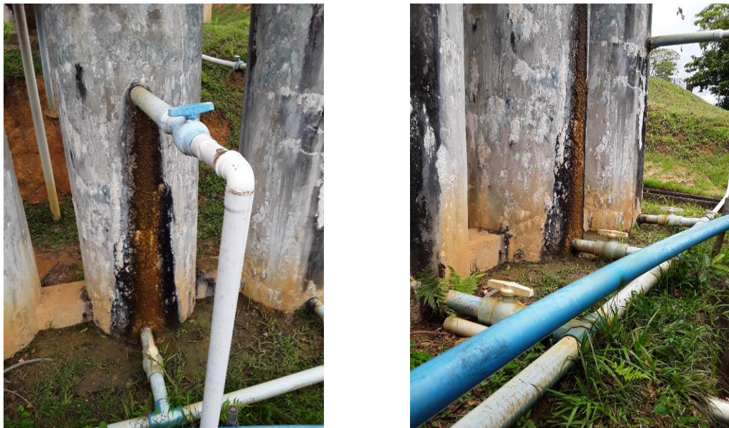
Figura 74 – Vazamento na estrutura do reservatório
