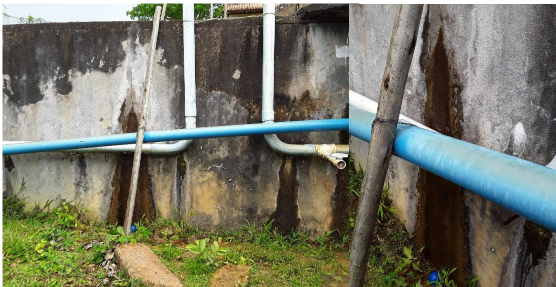
Figura 81 – Infiltrações no tanque de contato
