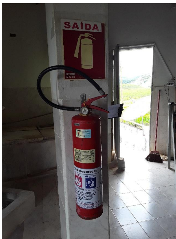
Figura 46 – Extintor de incêndio da casa de química
