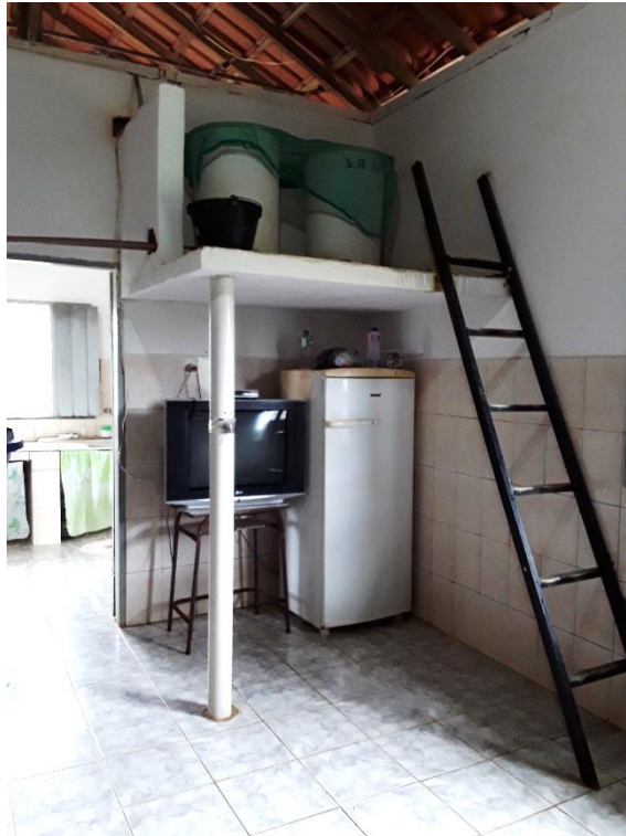
Figura 85 – Área de preparo do cloro e do sulfato de alumínio
