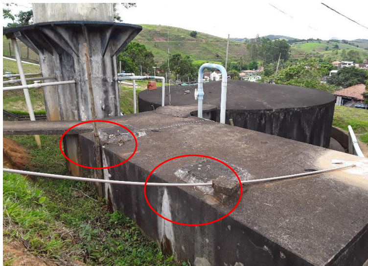
Figura 80 – Tanque de Contato
