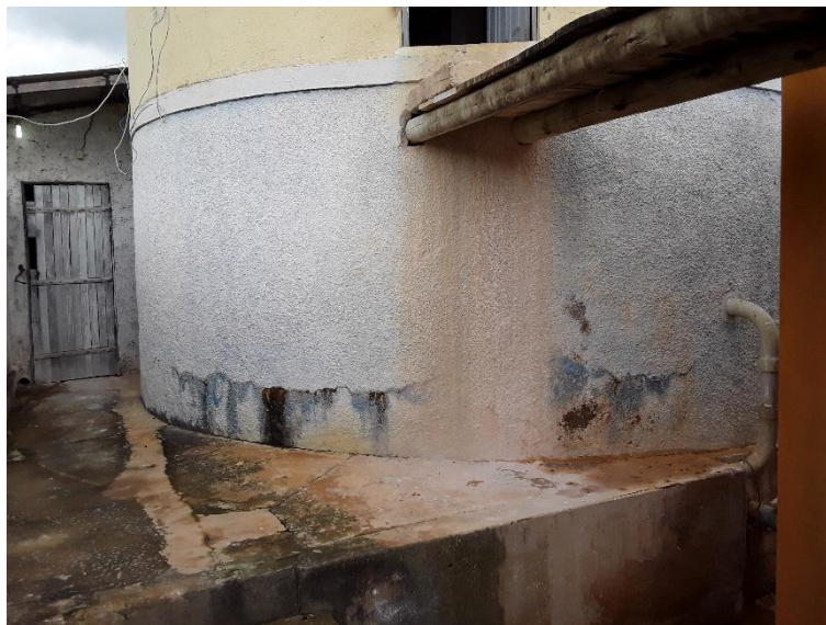
Figura 38 – Parte externa do tanque de contato
