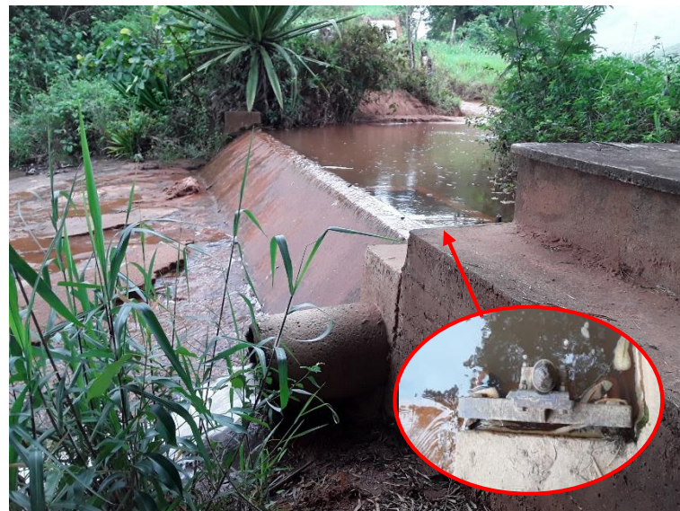
Figura 19 – Captação em barragem de nível
