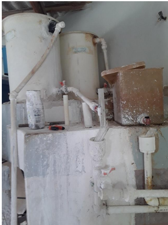
Figura 44 – Dosagem do sulfato de alumínio e da cal
