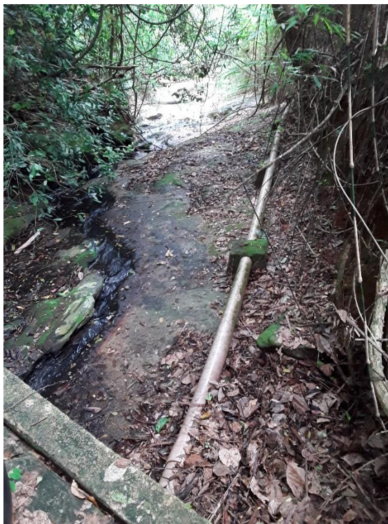
Figura 64 – Adutora da captação no córrego Santo Antônio
