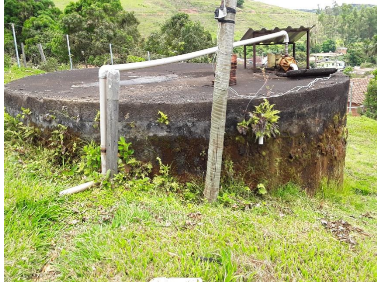
Figura 75 – Reservatório para armazenamento de água para lavagem dos filtros
