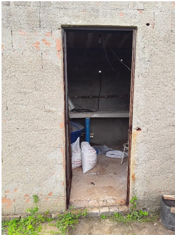
Figura 97 – Depósito de produtos químicos
