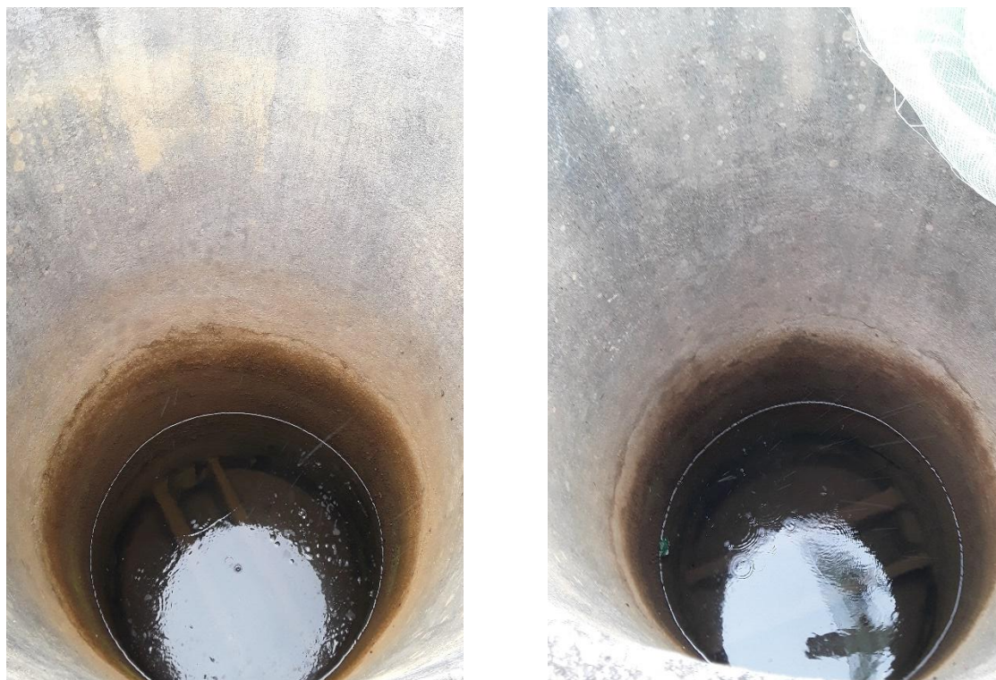
Figura 72 – Área interna dos filtros
