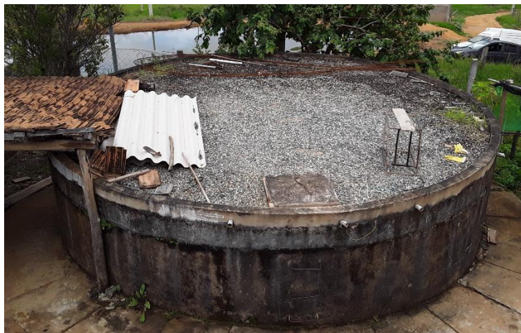
Figura 42 – Materiais diversos na cobertura do reservatório
