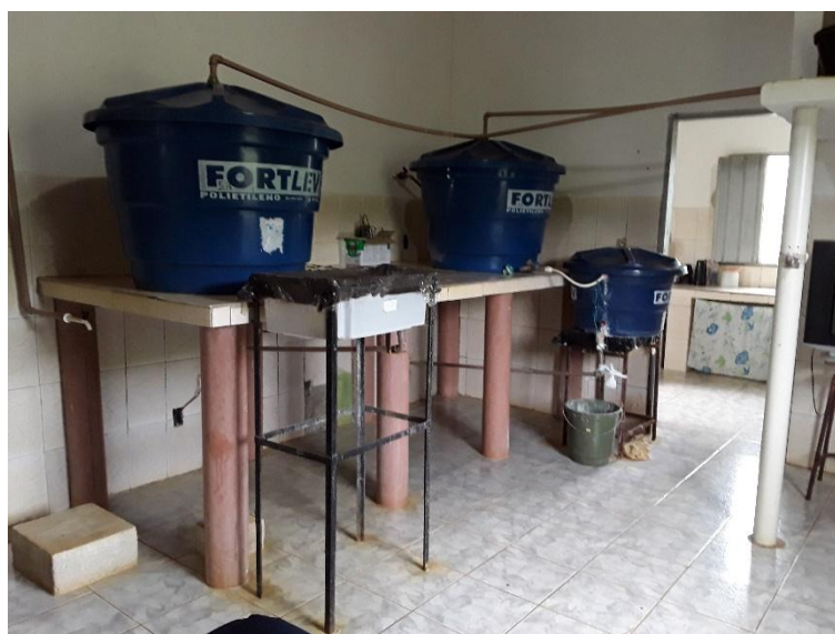
Figura 86 – Área de dosagem dos produtos químicos
