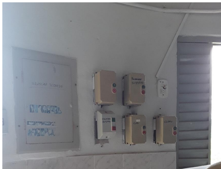
Figura 45 – Painel de controle das bombas
