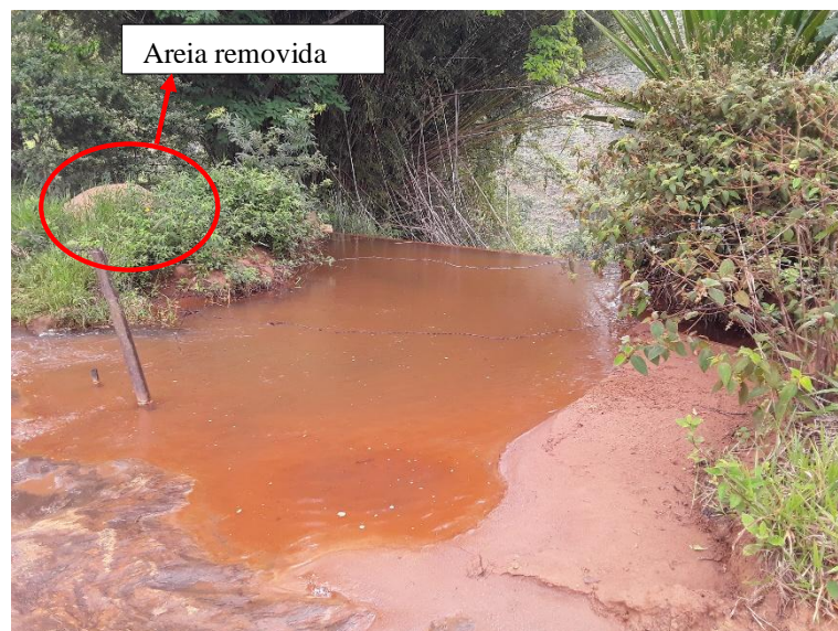
Figura 24 – Sinais de assoreamento
