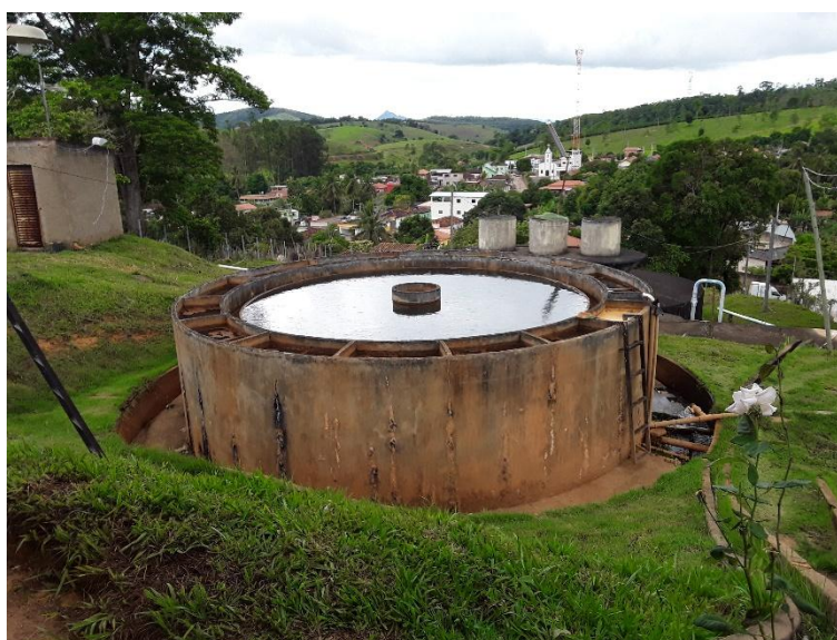
Figura 69 – Câmaras de floclação e decantador
