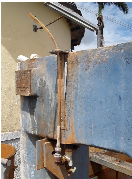
Figura 29 – Mangueira de nível na lateral da calha para medição de vazão
