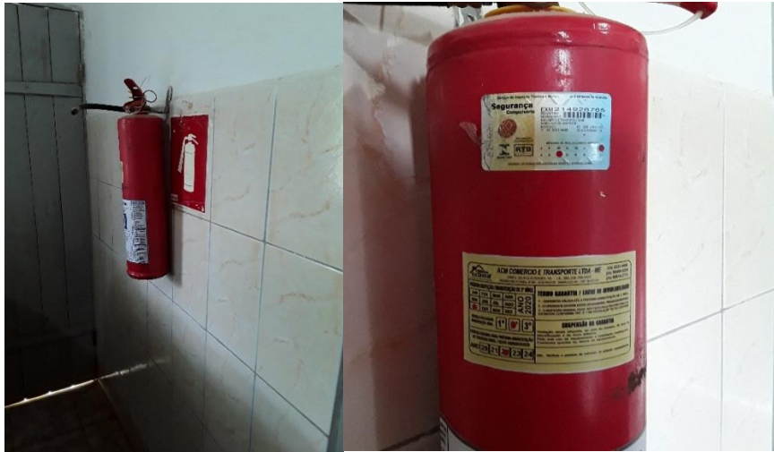
Figura 88 – Extintor de incêndio da casa de química
