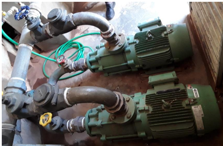
Figura 57 – Conjuntos motobomba - Esplanada
