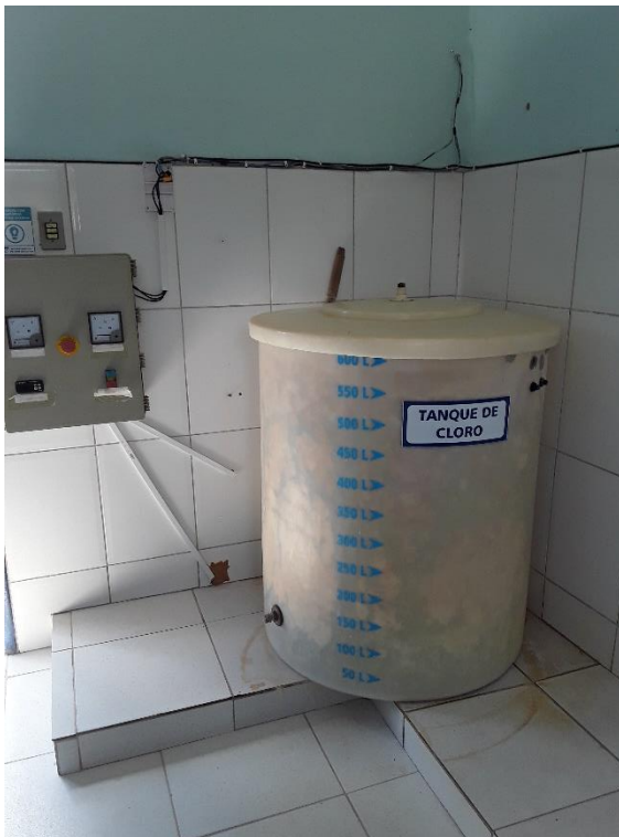
Figura 23 – Tanque de Cloro
