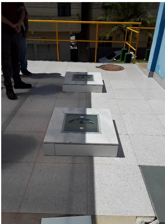
Figura 17 – Tanque de contato
