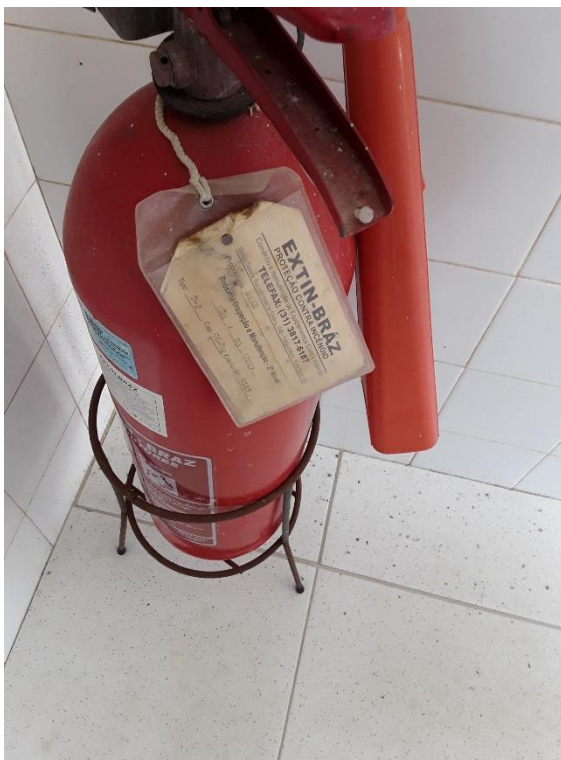
Figura 18 – Extintor de incêndio
