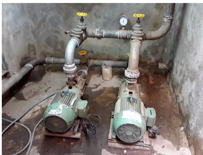
Figura 42 – Conjuntos motobomba - Cruzeiro
