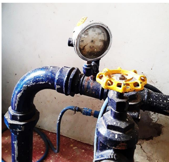
Figura 50 – Manômetro – Vale do Sol e Alvorada
