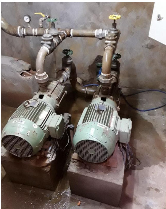
Figura 46 – Conjuntos motobomba – Bom Clima
