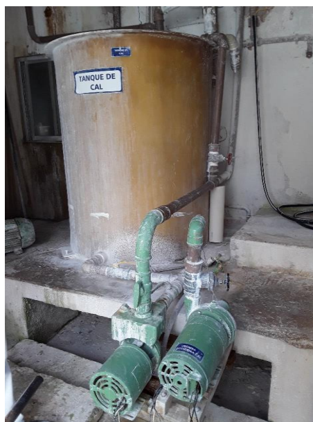
Figura 24 – Tanque de CAL
