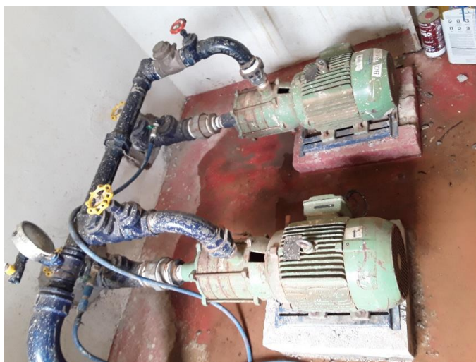
Figura 49 – Conjuntos moto bomba – Vale do Sol e Alvorada
