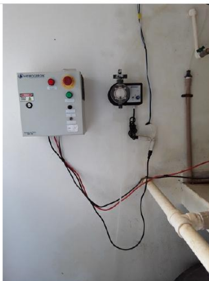
Bomba dosadora de hipoclorito de sódio
