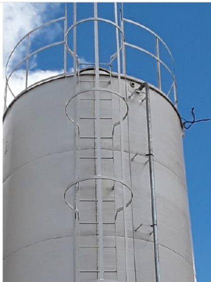
Tampa de inspeção sem cadeado e meio aberta.
