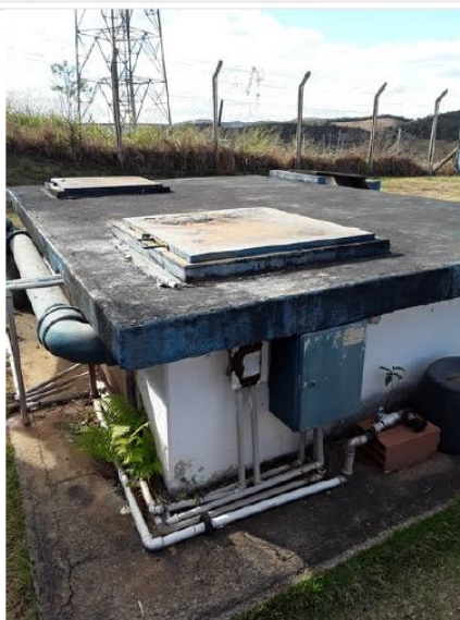
Tanque de contato
