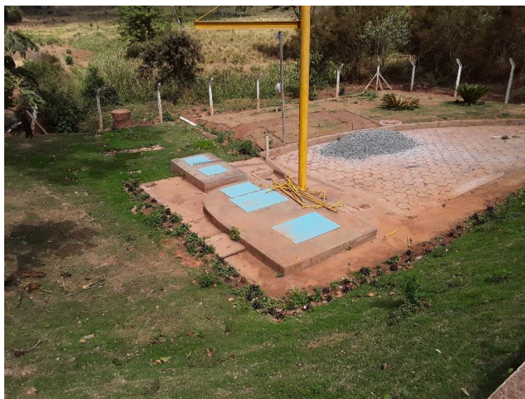
Figura 2 – Estação elevatória de esgoto
