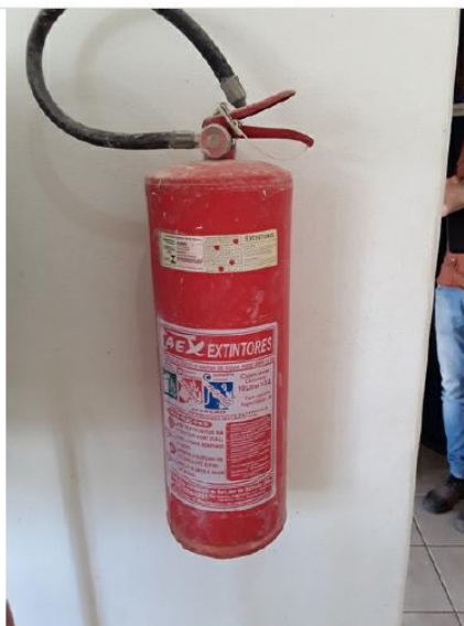
Extintor de incêndio
