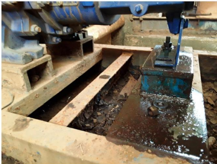
Vazamento no conjunto motobomba
