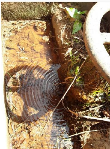
Vazamento no registro
