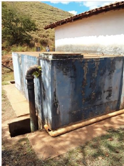
Reservatório de água bruta - Sucção
