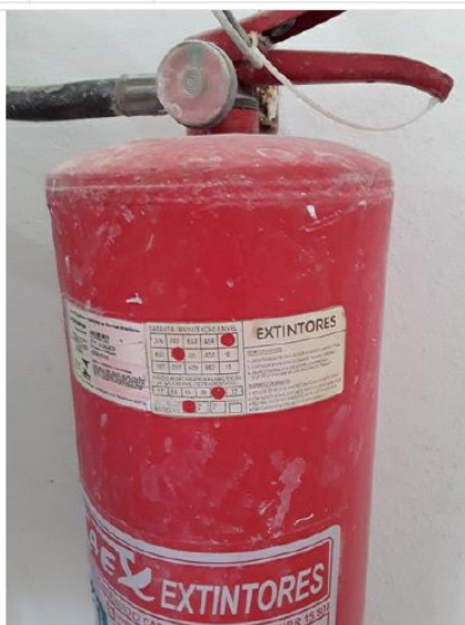
Extintor de incêndio com a carga vencida
