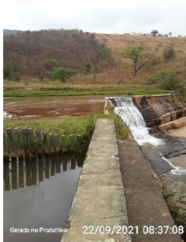
Captação Córrego João Pinto
