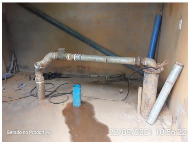
Poço da Escola - Ferruginha
