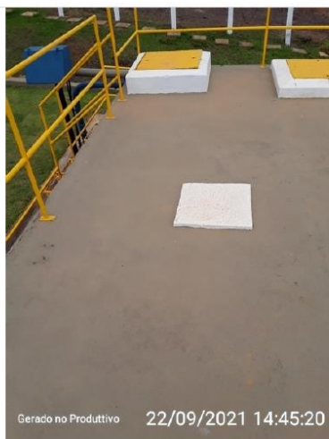
Tanque de contato
