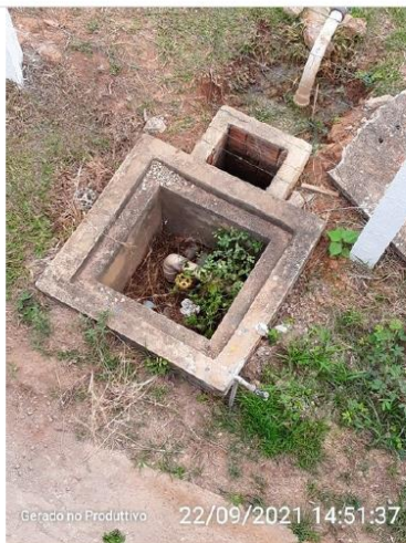
Válvula de fechamento na saída do reservatório
