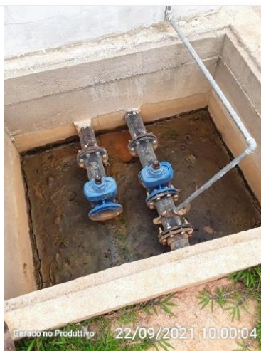
Válvula de fechamento na saída do reservatório
