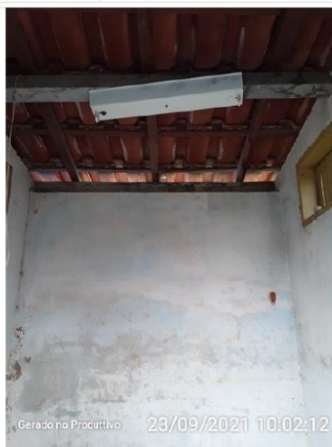
Iluminação da casa de bomba
