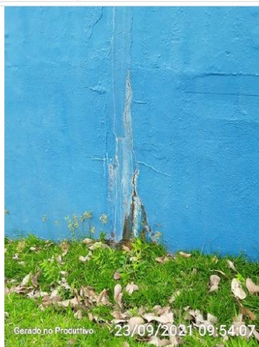
Infiltração na estrutura do reservatório
