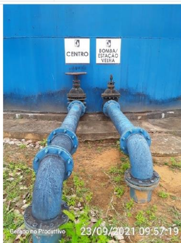
Válvulas na saída do reservatório
