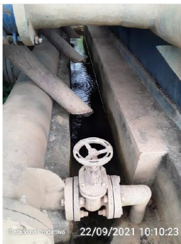
Vazamento na tubulação dos filtros
