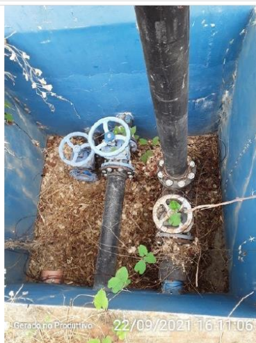
Válvula na entrada do reservatório
