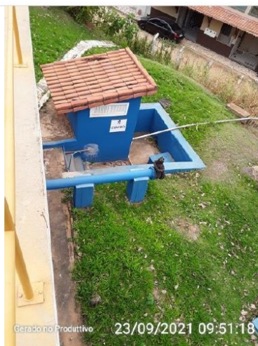
Descarga de fundo
