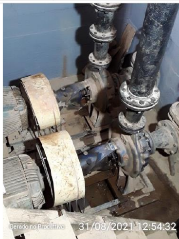
Vazamento nos conjuntos motobomba
