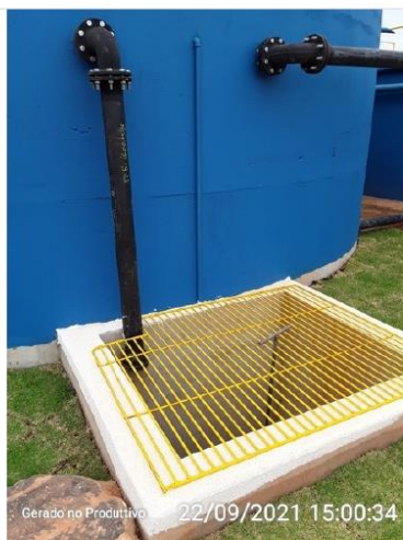
Caixa de descarga
