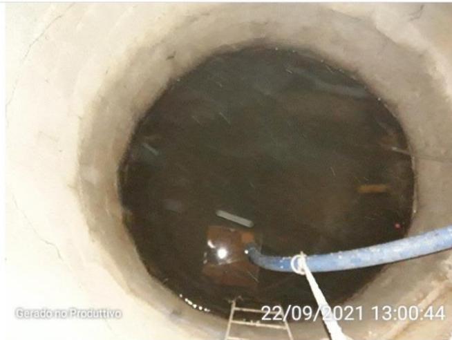
Reservatório de sucção
