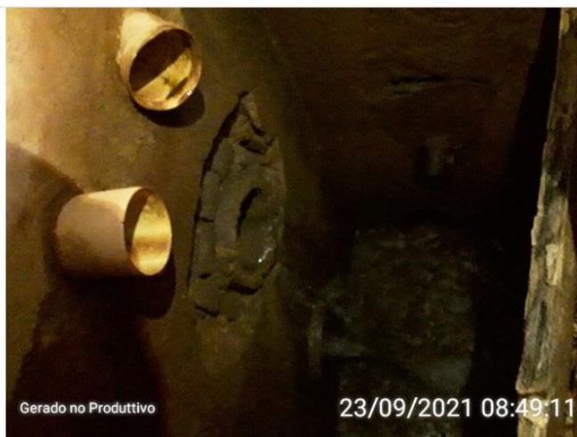
Vazamento proveniente da falta de vedação dos registros
