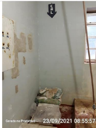
Sala de dosagem
