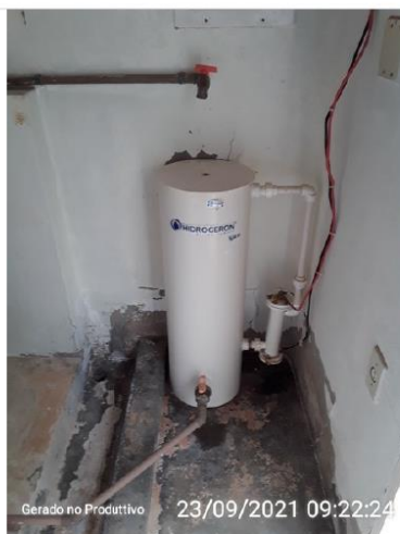
Gerador de hipoclorito
