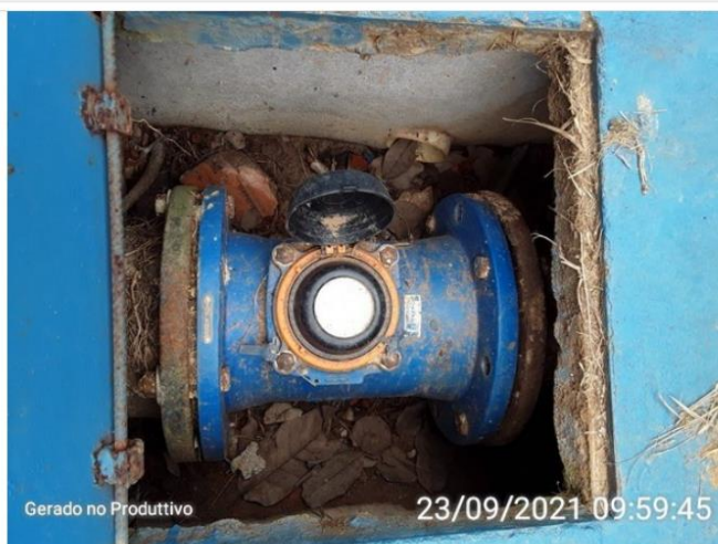
Medidor de vazão
