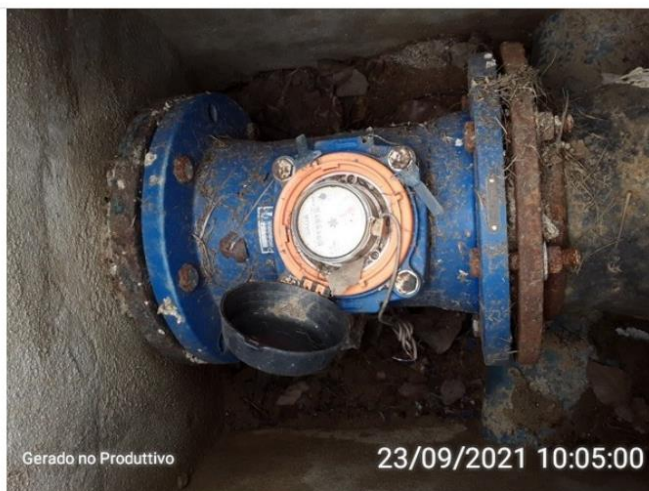
Medidor de vazão
