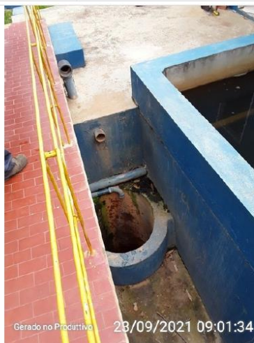
Local sem guarda-corpo
