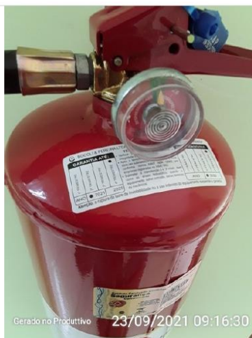
Extin tor de incêndio
