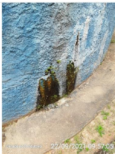
Infiltração na estrutura do reservatório
