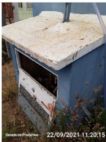
Área do acondicionamento do conjunto motobomba
