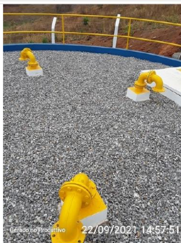
Tubulação de ventilação
