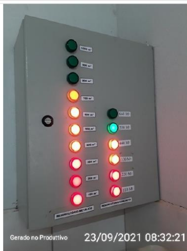
Painel de controle do nível do reservatório
