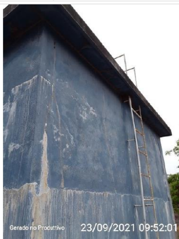
Infiltração no reservatório
