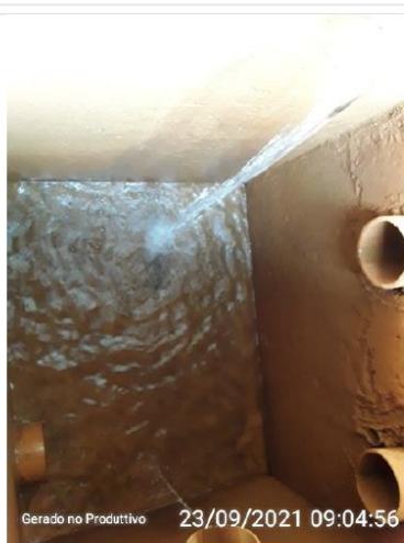
Vazamento proveniente da falta de vedação dos registros
