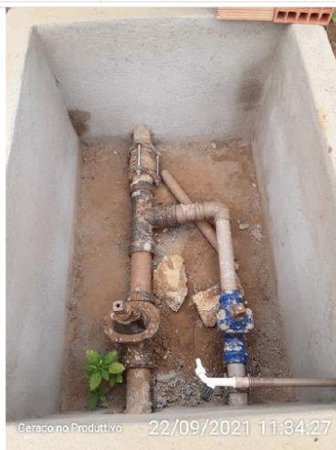
Válvula na saída do reservatório
