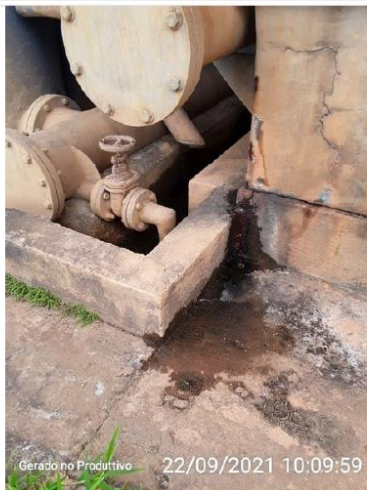
Vazamento na base dos filtros
