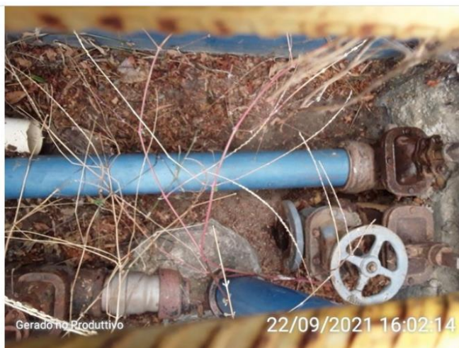
Válvula na entrada do reservatório
