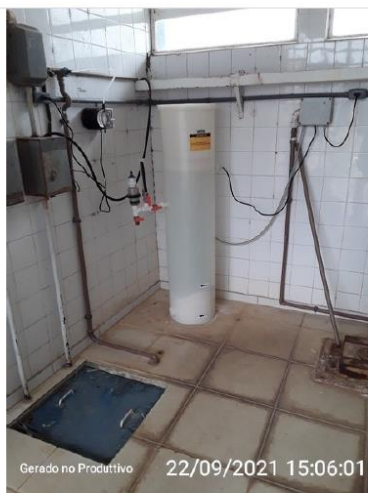
Gerador de hipoclorito de sódio
