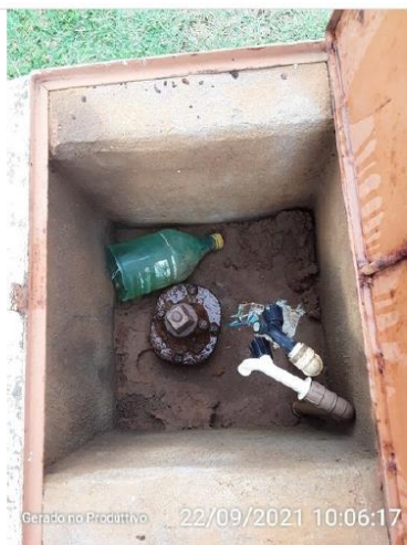
Válvula do reservatório
