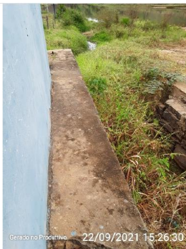
Captação Rio Caratinga - Barra do Cuieté
