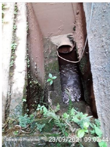
Vazamento proveniente dos decantadores
