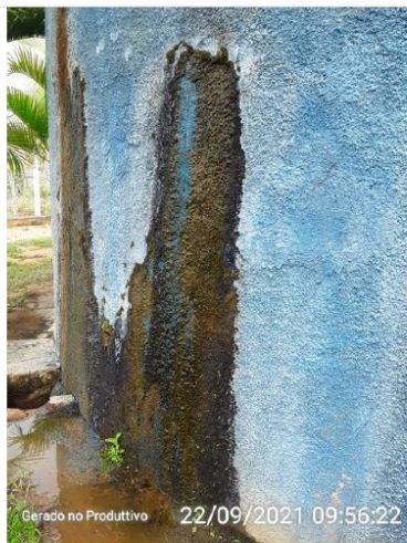
Vazamento na estrutura do reservatório
