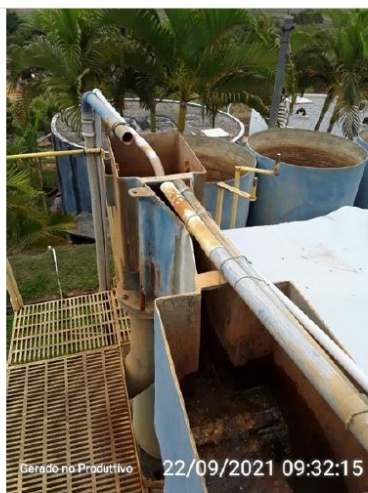
Calha Parshall da ETA
