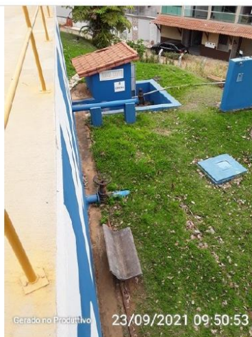
Válvula na saída do reservatório
