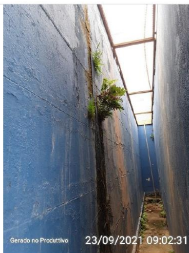
Vazamento na estrutura da ETA
