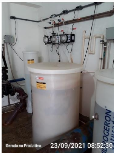
Tanques do gerador de hipoclorito de sódio
