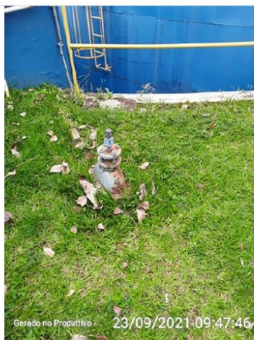
Válvula na entrada do reservatório
