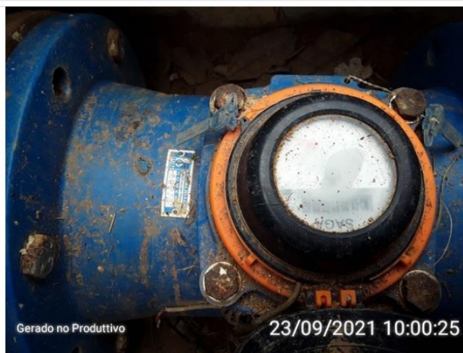
Medidor de vazão
