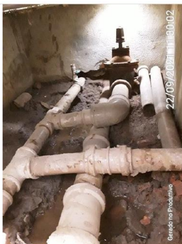
Válvula na saída do reservatório
