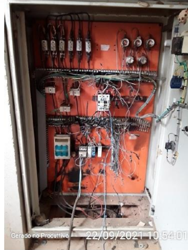
Condições aparentes do quadro elétrico.
