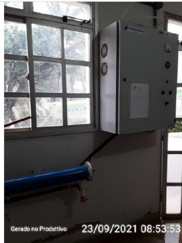
Gerador de hipoclorito de sódio
