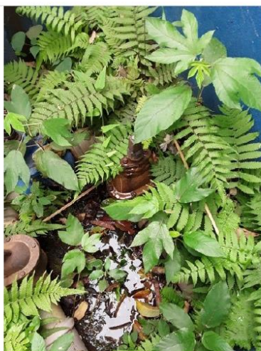
Vazamento no registro do filtro
