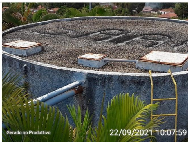
Tampas do reservatório oxidadas.
