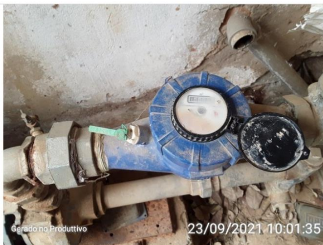
Medidor de Vazão
