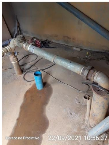
Poço da Escola - Ferruginha (2)
