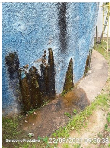
vazamento na estrutura do reservatório
