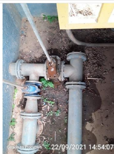
Registro com vazamento
