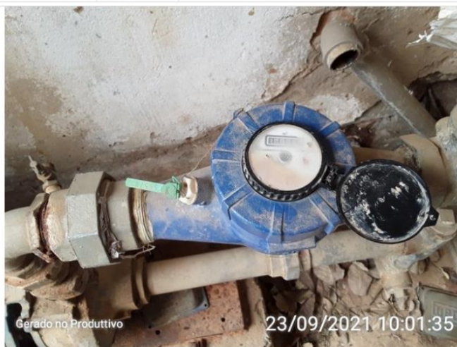
Medidor de vazão
