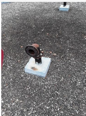
Tubulações de ventilação
