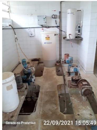
Área de preparo e dosagem de produtos químicos
