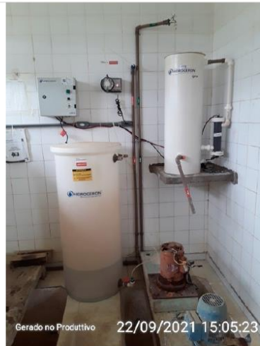
Gerador de hipoclorito de sódio
