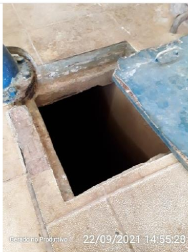
Tampa de inspeção do tanque de contato
