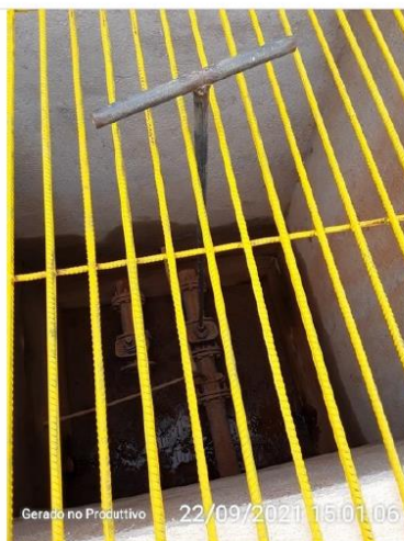
Válvula de fechamento na saída do reservatório
