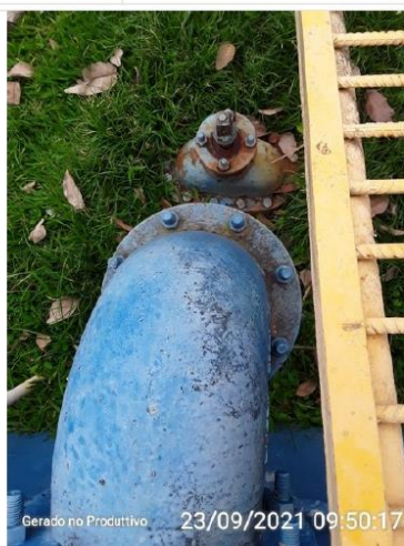
Válvula na entrada do reservatório
