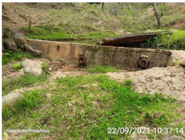
Ausência de fluxo residual a jusante do barramento
