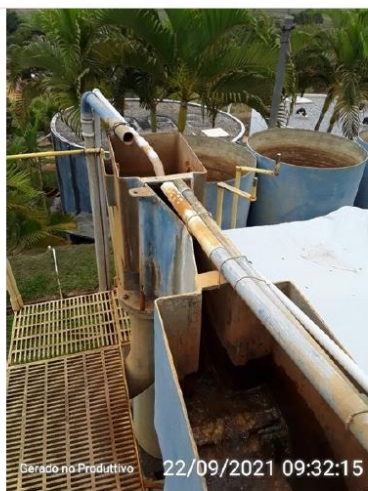
Calha Parshall da ETA
