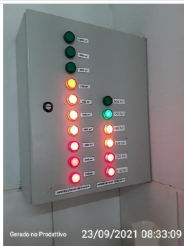
Painel de controle de níveis dos reservatórios
