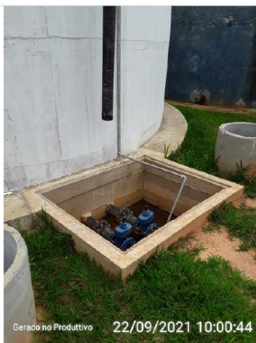
Caixa de descarga
