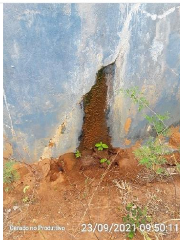
Vazamento no reservatório
