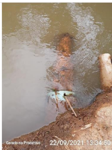
Captação Córrego da Penha Montante - Penha do Norte
