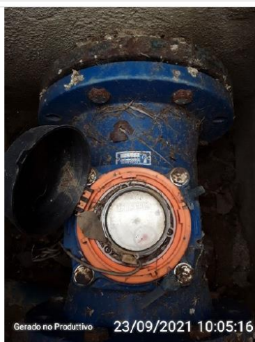
Medidor de vazão
