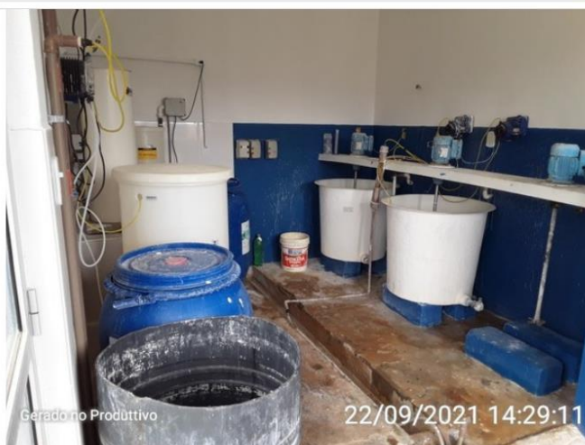
Local de preparo dos produtos químicos
