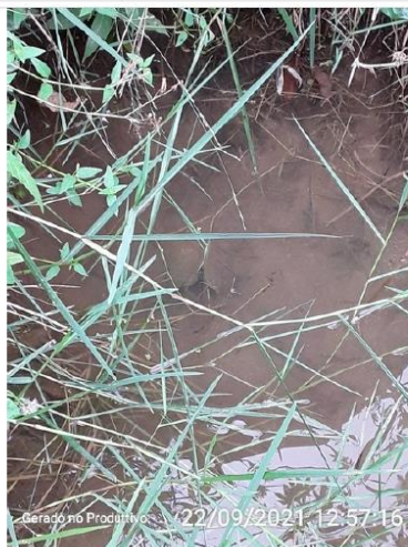
Ponto de captação sem grades ou telas
