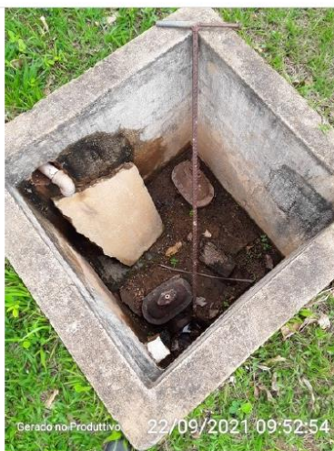
Válvula de fechamento na saída do reservatório
