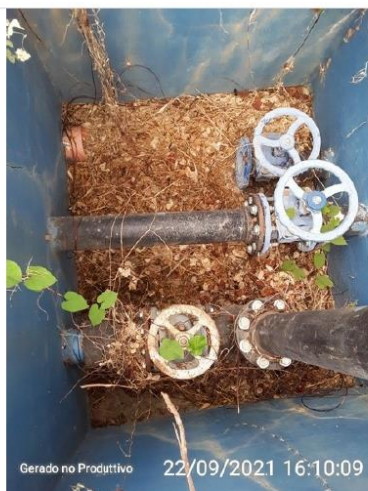
Descarga de fundo
