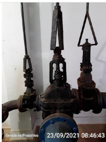
Válvulas de gaveta com vazamento
