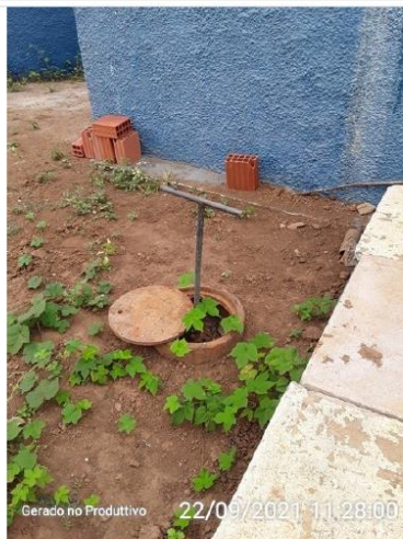
Válvula na entrada do reservatório
