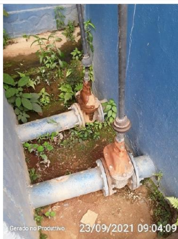
Válvulas de gaveta com vazamento
