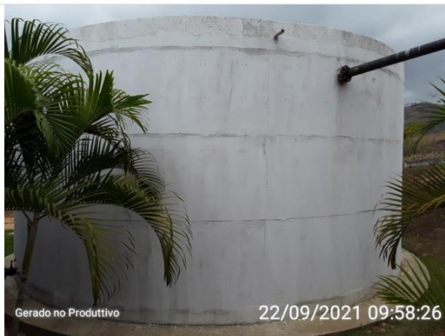
Reservatório ETA II
