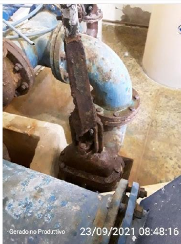
Válvulas de gaveta com vazamento
