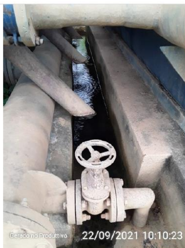
Vazamento na tubulação dos filtros
