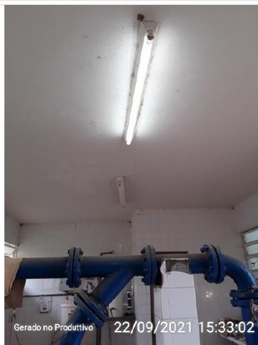
Iluminação da sala de bombas
