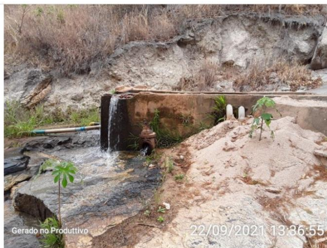
Caixa de passagem na captação
