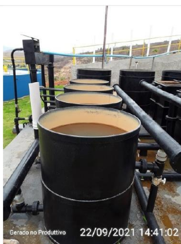
Filtros utilizados na ETA
