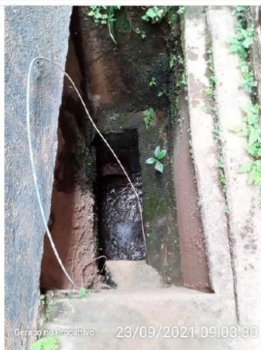
Vazamento proveniente dos decantadores
