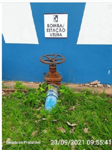
Válvula na saída do reservatório
