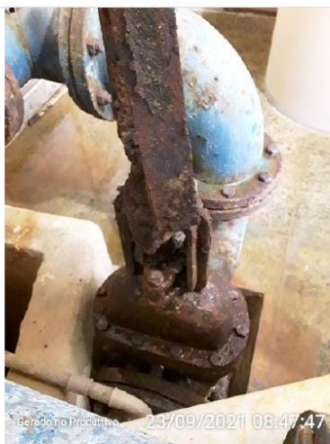
Válvulas de gaveta com vazamento
