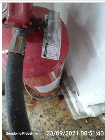
Extin tor de incêndio
