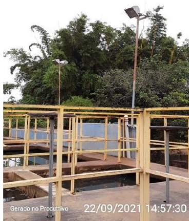
Iluminação na área da ETA
