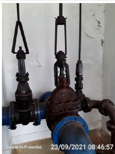
Válvulas de gaveta com vazamento
