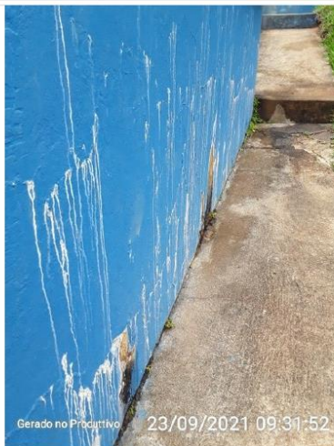
Infiltração no filtro
