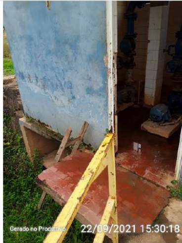
Área sem guarda - corpo
