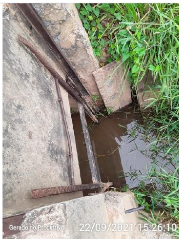
Captação Rio Caratinga - Barra do Cuieté
