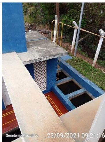
Local sem guarda-corpo
