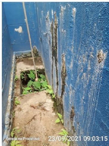
Infiltrações na estrutura da ETA
