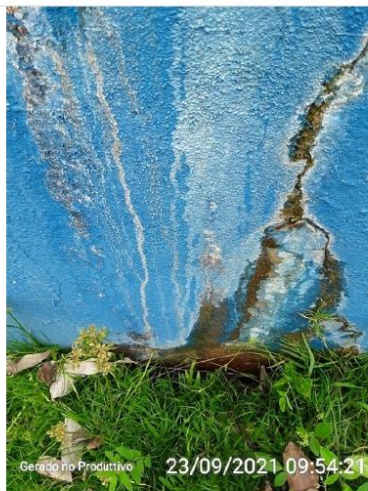
Vazamento na estrutura do reservatório
