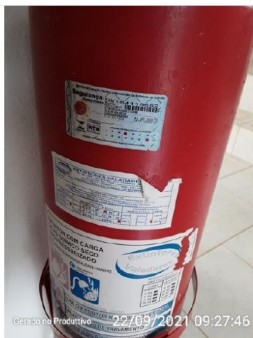
Extintor de incêndio dentro da validade.
