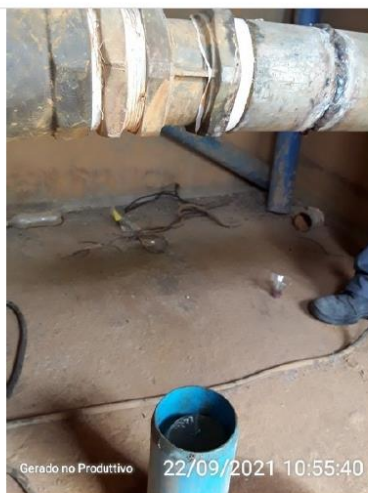
Vazamento na tubulação do poço.
