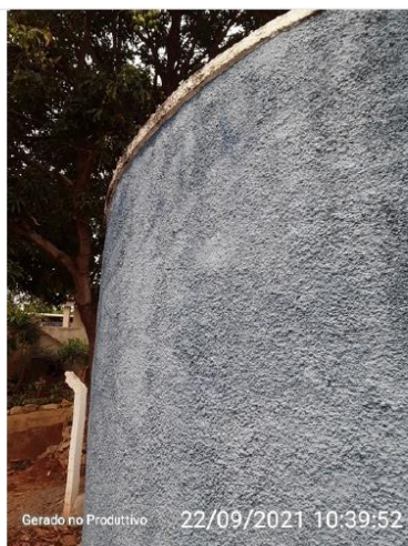
Reservatório São Vicente
