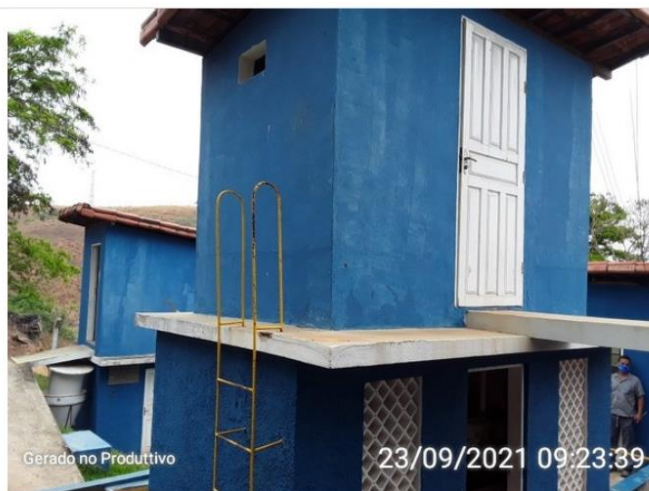
Local sem guarda-corpo
