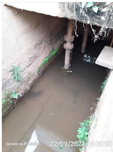
Captação Rio Caratinga - Barra do Cuieté
