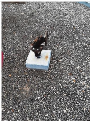
Tubulações de ventilação
