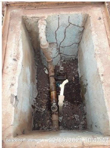
Válvula da saída do reservatório
