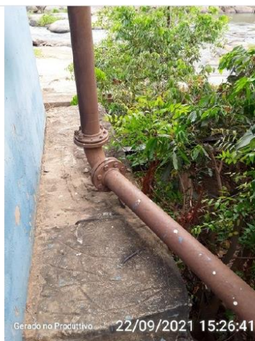
Captação Rio Caratinga - Barra do Cuieté
