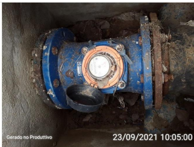
Medidor de Vazão
