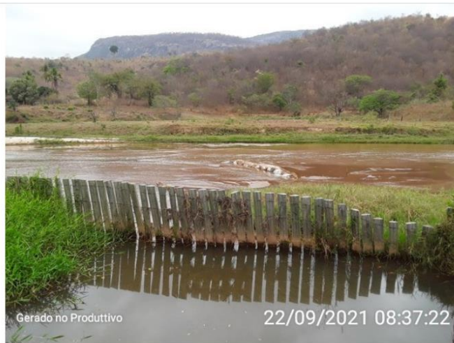
Captação Córrego João Pinto
