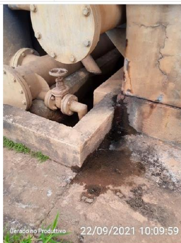
Vazamento na base dos filtros
