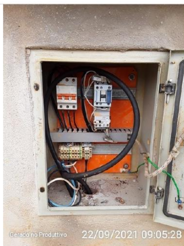
Condições aparentes do quadro elétrico.
