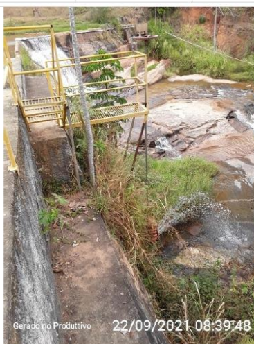
Vazamento na descarga de fundo
