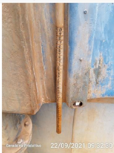
Régua utilizada para a medição de vazão na entrada da ETA
