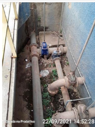
Registro dos filtros
