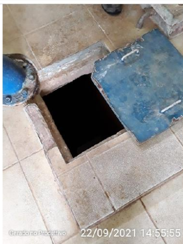
Tampa de inspeção do tanque de contato
