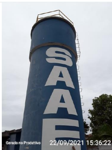
Reservatório de armazenamento de água de Lavagem dos filtros
