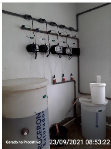
Área de dosagem
