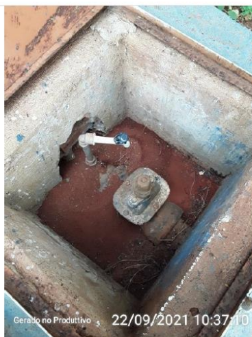
Válvula na saída do reservatório
