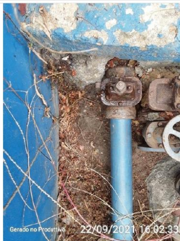
Válvula na saída do reservatório
