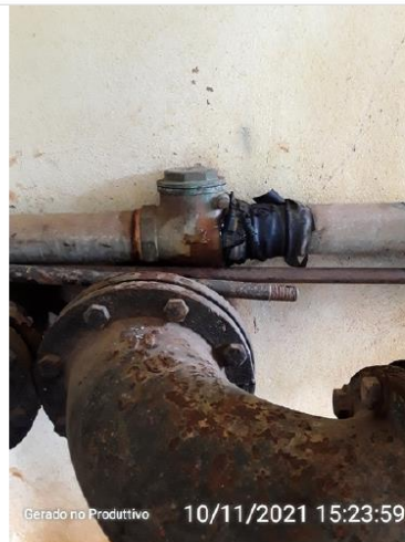
Tubulação dos filtros
