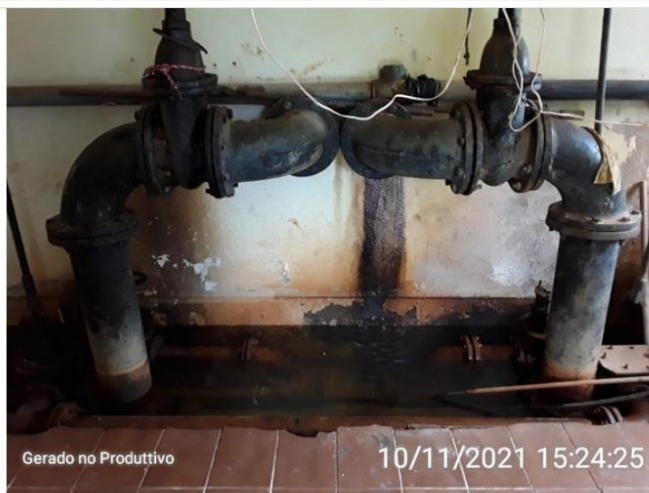
Tubulação dos filtros
