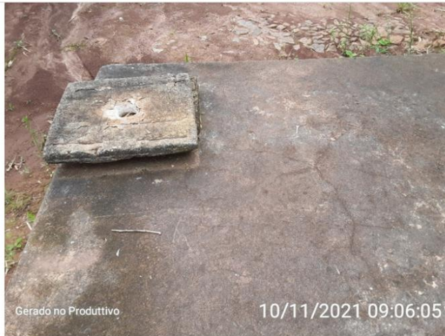
Tanque de contato
