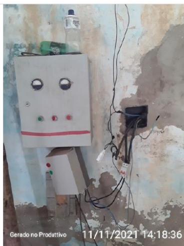
Fios e painel de controle
