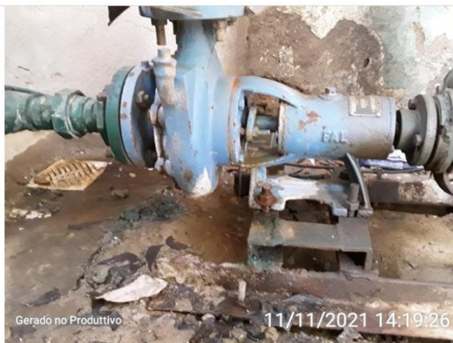
Vazamento no conjunto motobomba
