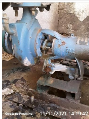
Vazamento no conjunto motobomba
