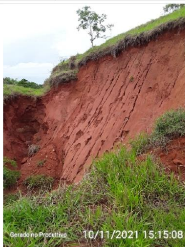
Deslizamento de Terra
