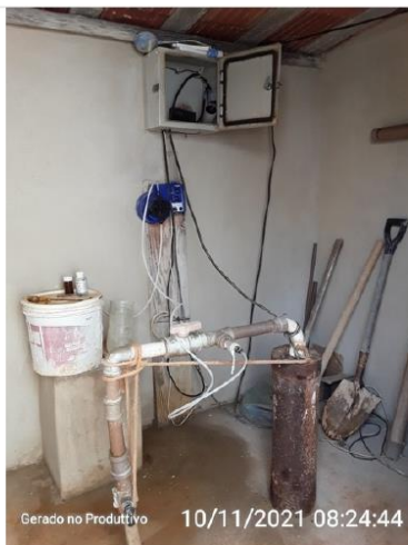
Sistema de cloração
