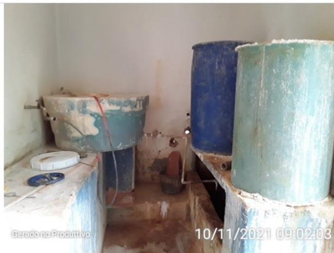
Sala de dosagem
