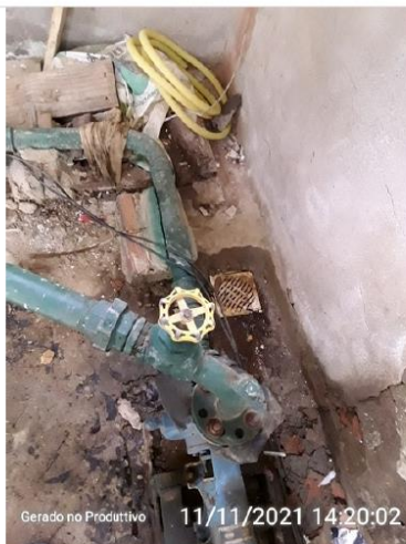
Ralo para drenagem da água
