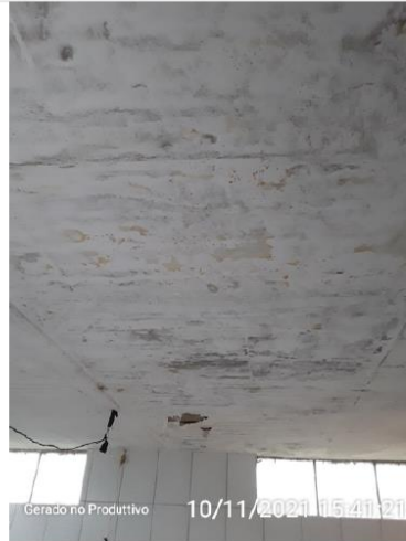
Teto do laboratório com infiltrações
