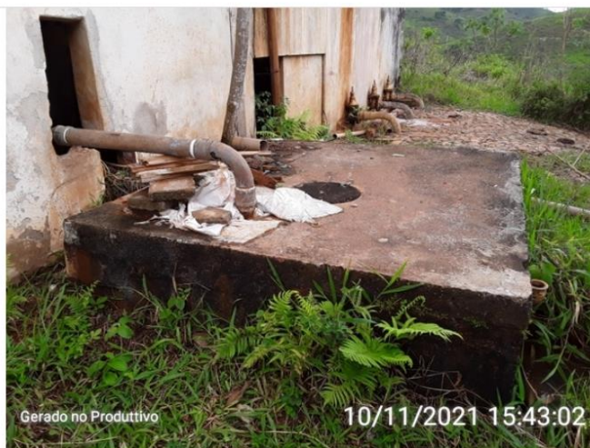
Tanque de contato
