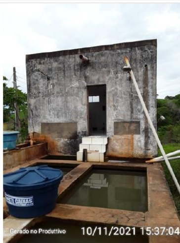
Iluminação na área da ETA
