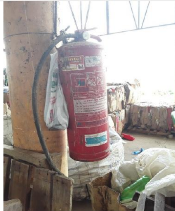
Extintor de incêndio em desuso.
