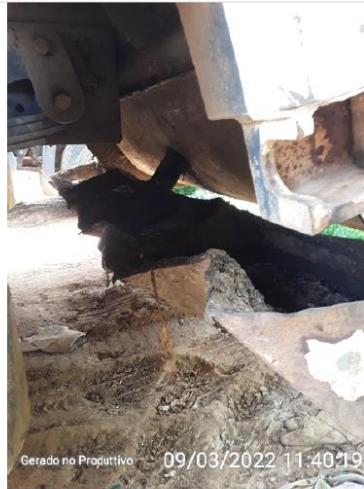
Calha coletora de chorume.
