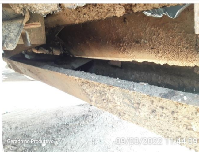
Calha coletora de chorume.
