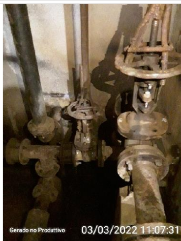
Vazamento no registro do filtro - ETA
