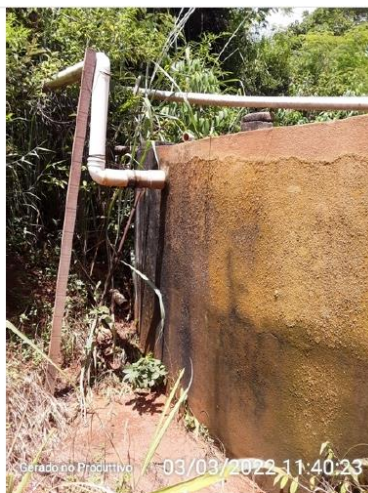
Tubos de entrada de água no reservatório e estruturas apresentando marcas de vazamentos.
