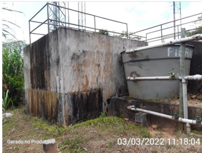
Estrutura da ETA com patologias.
