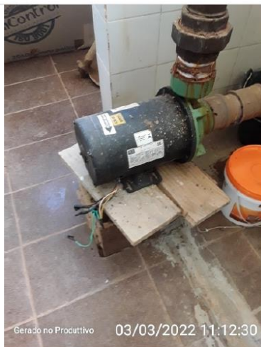
Cabos elétricos expostos
