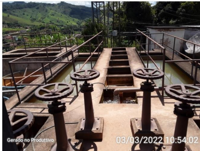
Locais dos Floculadores sem guarda- corpo
