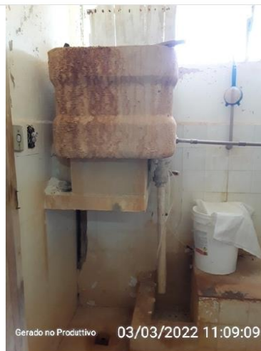
Caixa de mistura dos produtos químicos.
