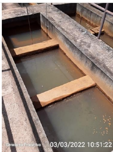
Floculadores sem formação de flocos na água.
