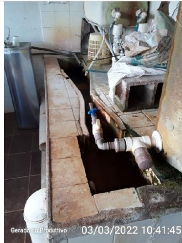
Vista superior da Calha Parshal.
