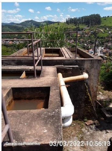
Local sem guarda-corpo.
