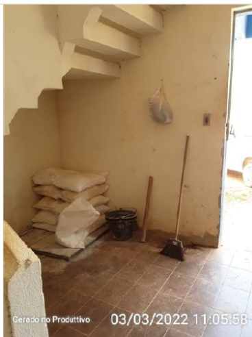
Armazenamento irregular de produtos químicos
