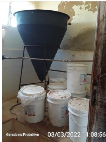
Espaço impróprio para armazenamento dos produtos químicos.
