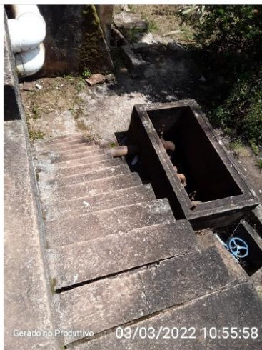
Escadas da ETA sem guarda-corpo.
