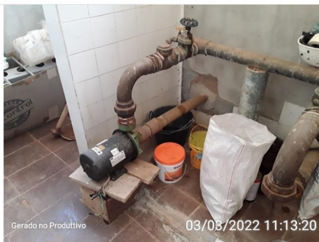
Tubos em condições inadequadas.
