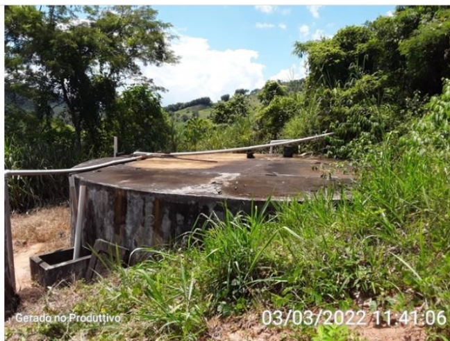
Vista superior do Reservatório necessitando drenagem e limpeza local
