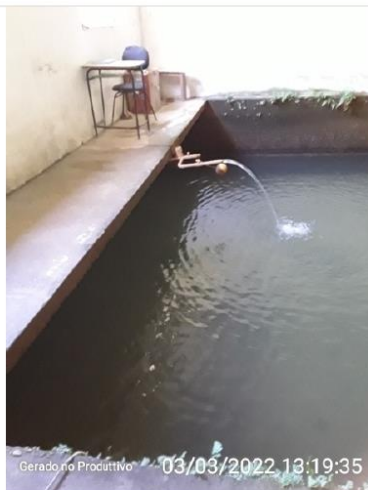
Registro de água sem medidor de vazão.
