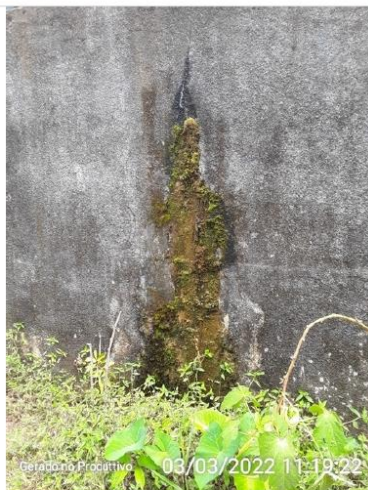
Vazamentos na estrutura da ETA.
