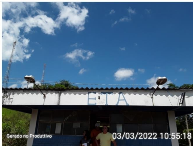
Iluminação na ETA.
