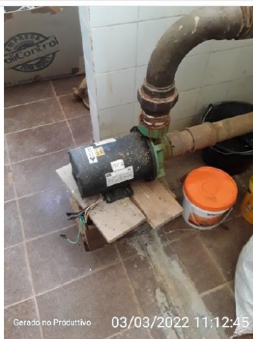
Cabos elétricos podendo ocasionar risco de choque
