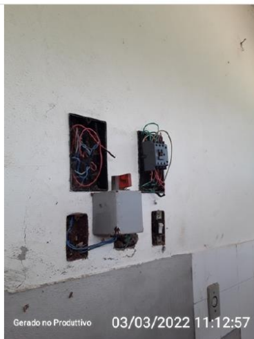
Quadros elétricos e cabos expostos.
