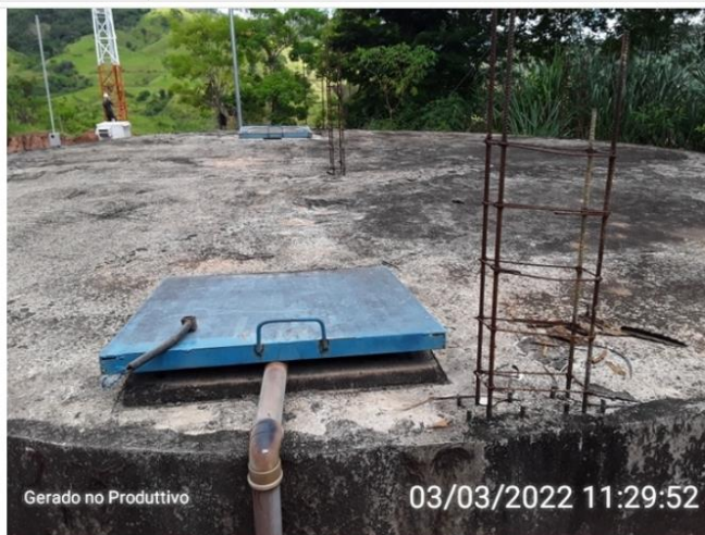
Cobertura do reservatório.
