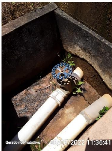
Válvula de fechamento na saída do Reservatório.
