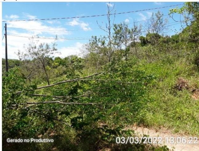
Cobertura Vegetal impedindo a passagem de acesso a ETE.
