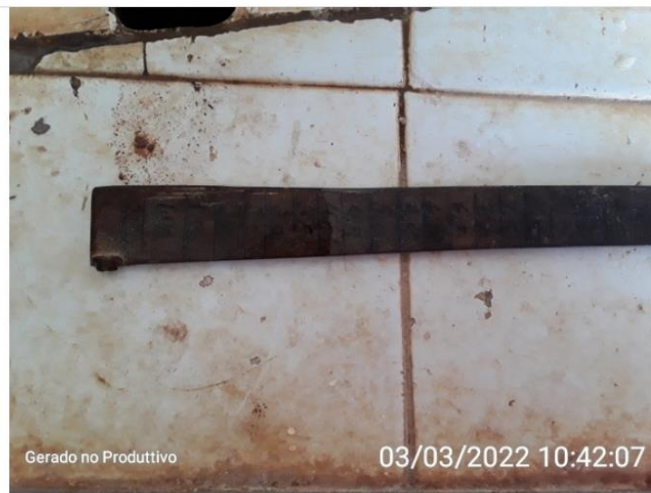
Régua graduada de medição de vazão necessitando melhorias
