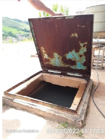
Tanque de Contato.
