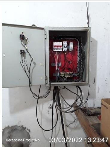
Quadros e cabos elétricos expostos
