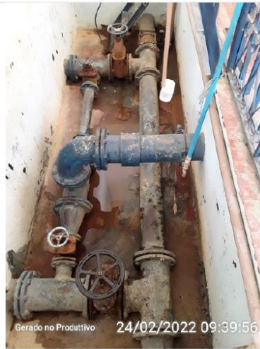
Válvulas com vazamentos.
