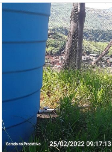
Válvula na saída do reservatório.
