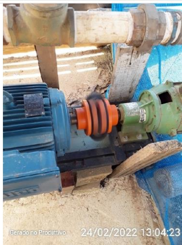
Gerado no Procutivo 24/02/2022 13:04:23 Conjunto Moto-bomba sem grade de proteção .
