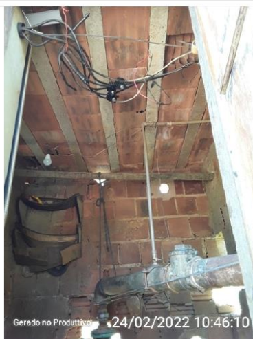
Parte elétrica e iluminação da casa de bombas.
