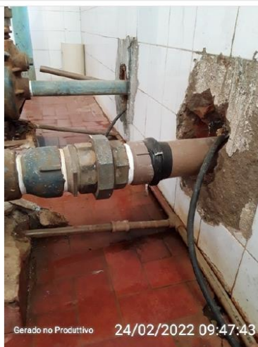
Vazamentos no conjunto moto-bomba
