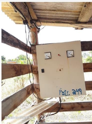
Cabos e quadros elétricos expostos.
