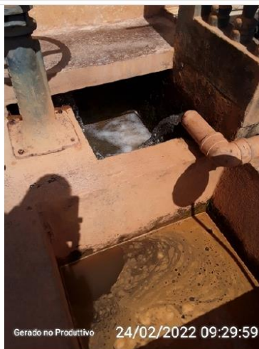
Chegada da água nos floculadores.
