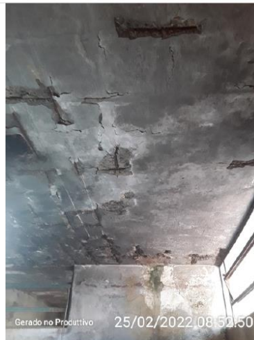
Patologias na estrutura da laje
