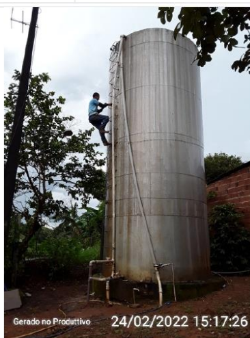
Escada de acesso sem guarda-corpo
