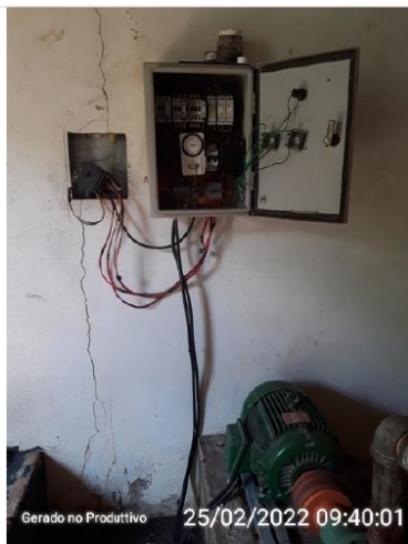
Quadros e cabos elétricos expostos
