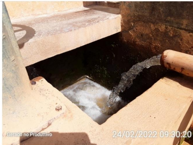
Chegada da água nos floculadores.
