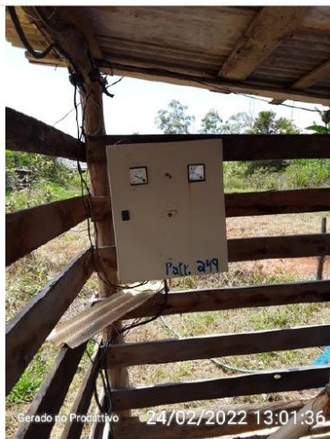
Quadros e cabos elétricos
