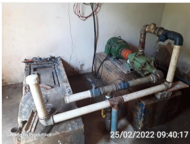
Casa de bombas
