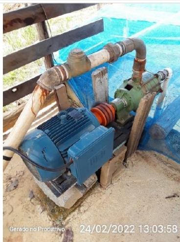
Conjunto moto-bomba único existente.
