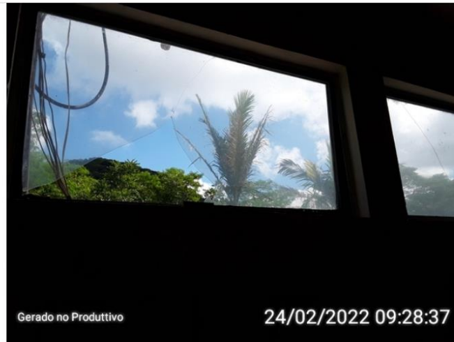
Janela do laboratório físico - químico com o vidro quebrado
