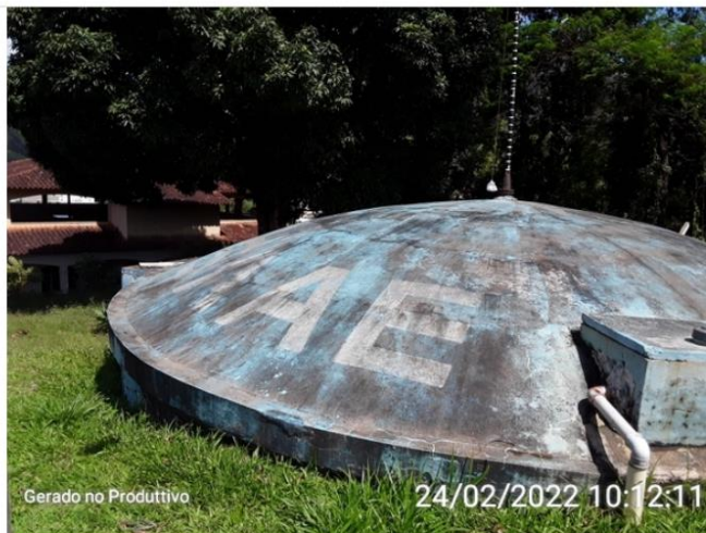
Identificação do reservatório apagada.
