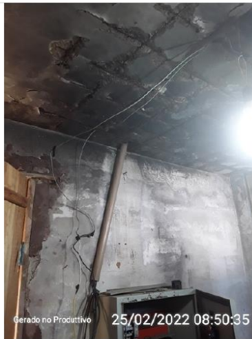
Instalações elétricas com risco eminente
