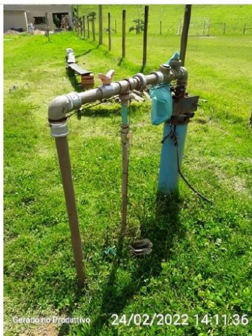
Local do poço de captação não possui laje sanitária de proteção.
