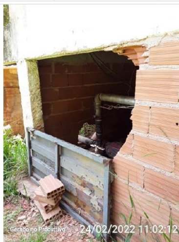
Local de acesso ao conjunto motobomba sem proteção.
