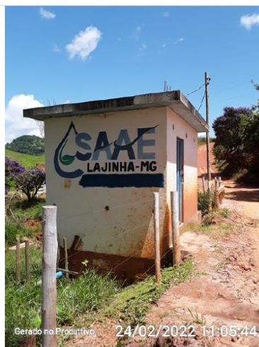
Estação Elevatória de Água Bruta
