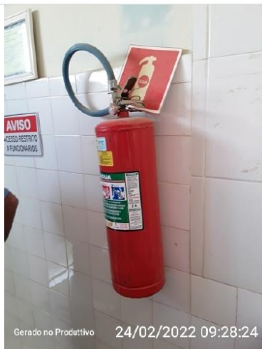
Extintor de incêndio.
