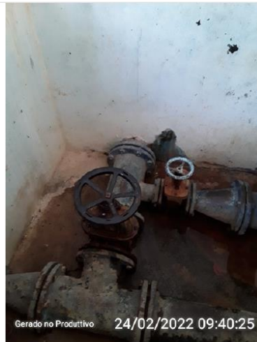
Válvulas com vazamentos.
