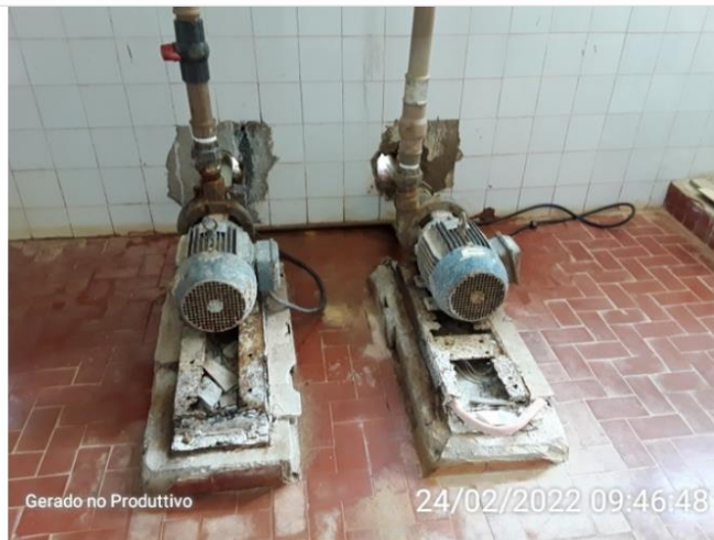
Conjunto moto-bomba reserva
