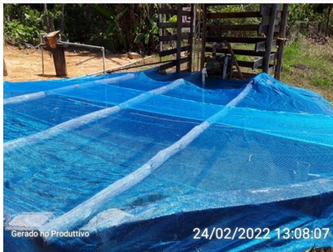
Tampas do reservatório enterrado
