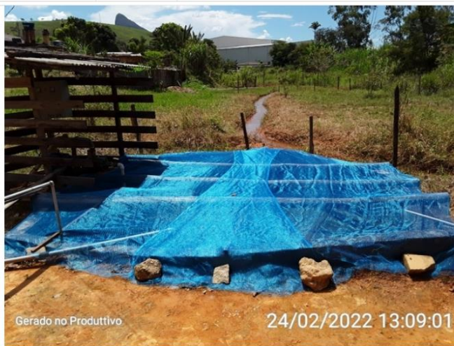
Tampa de proteção inadequada.
