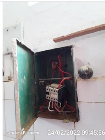
Parte interna dos painéis elétricos
