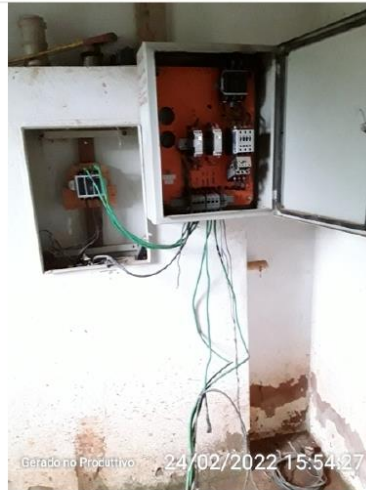
Cabos elétricos e painel com fios expostos.
