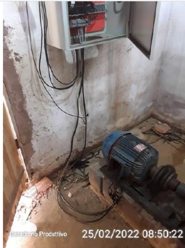
Cabos elétricos expostos
