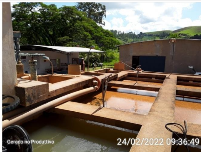
Área dos floculadores, decantadores e filtros
