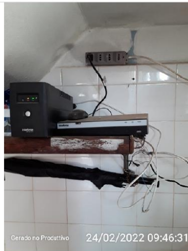
Instalações elétricas expostas
