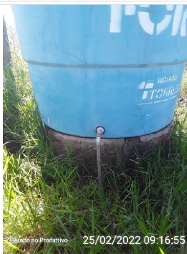
Válvula na saída do Reservatório
