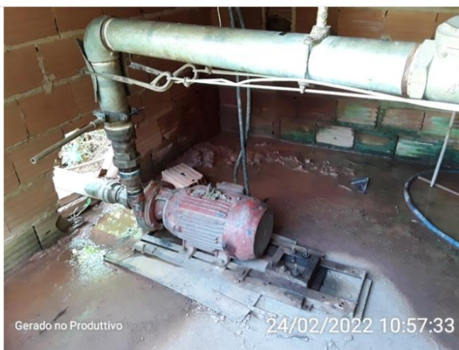
Casa de Bombas.
