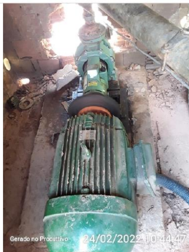
Conjunto Moto-bomba sem grades de proteção.
