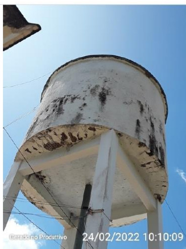
Reservatório com patologias.
