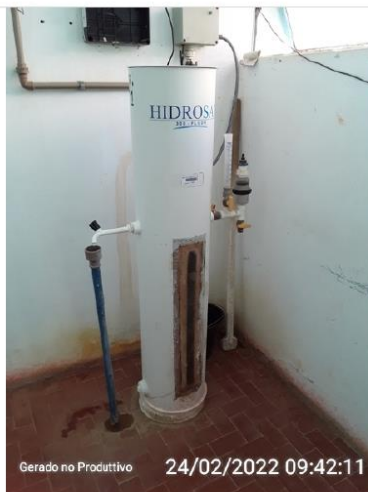
Processo de fluoretação da água de abastecimento.
