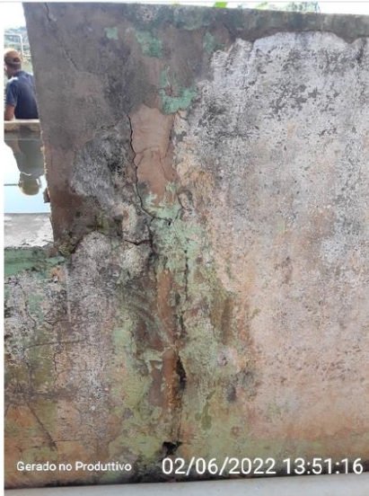
Infiltração na estrutura da ETA
