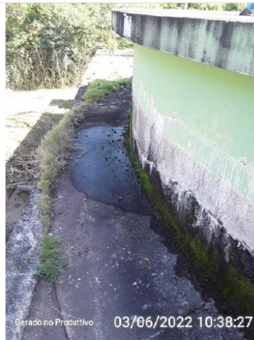
Vazamento na lateral do reservatório
