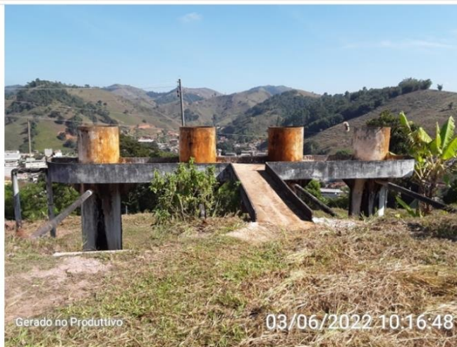
Área dos filtros
