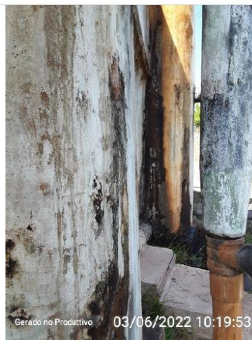
Infiltração na estrutura dos filtros
