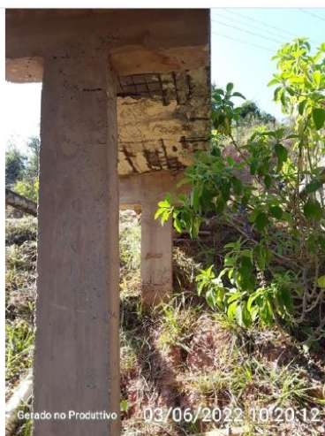
Presença de patologias na estrutura da rampa de acesso aos filtros
