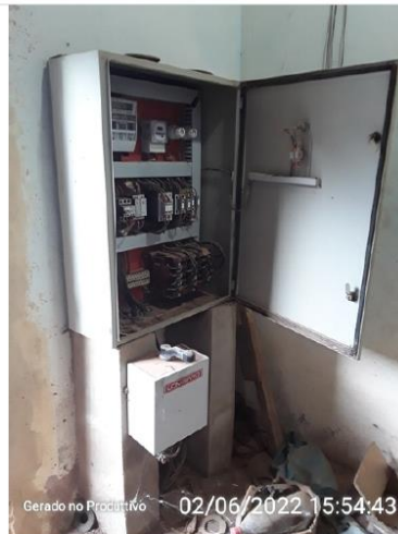
Quadro de comando
