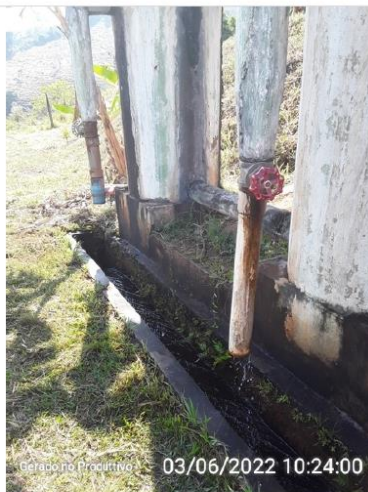
Vazamento nos registros de descarga dos filtros
