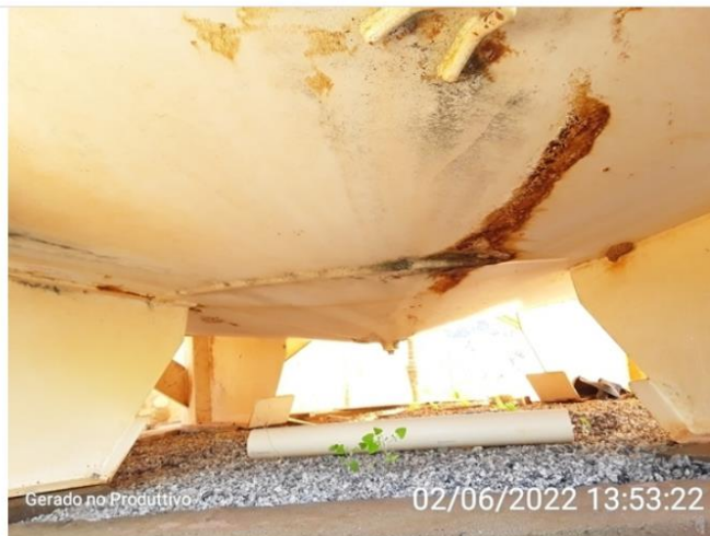
Ponto de infiltração do reservatório
