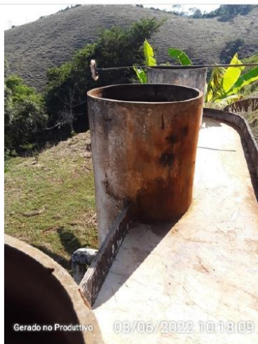
Área dos filtros
