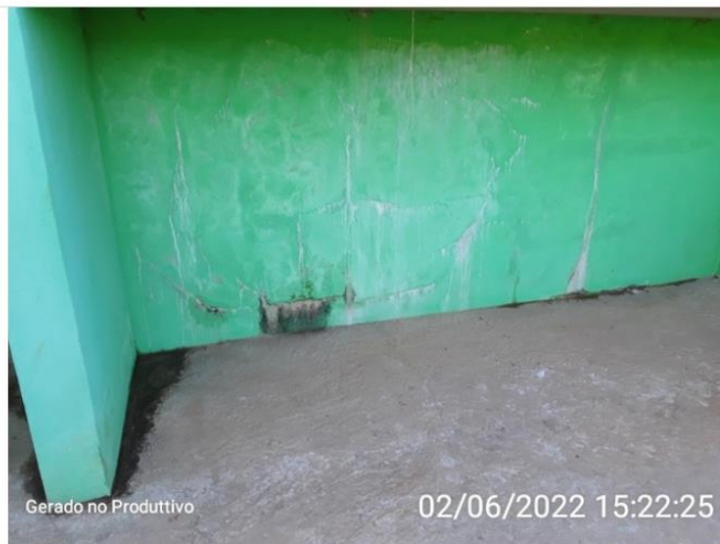
Infiltração na estrutura
