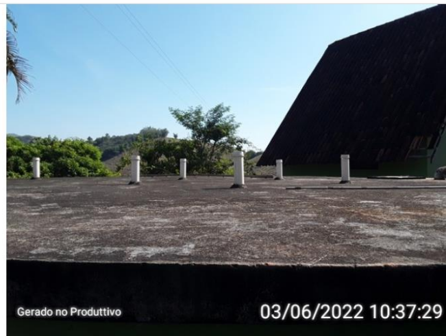
Tubos de ventilação
