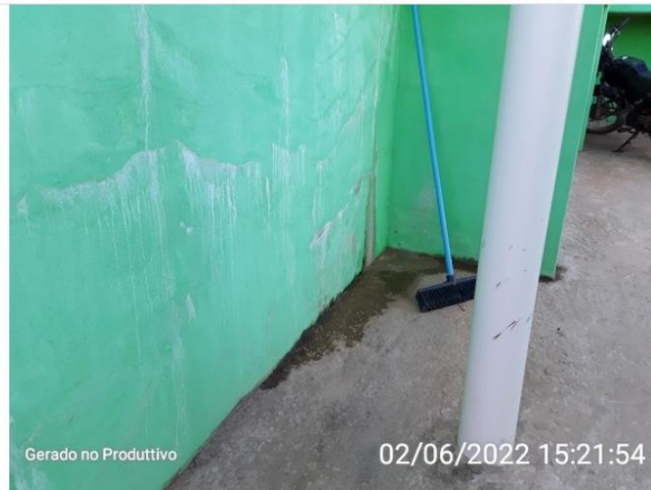
Infiltração na estrutura
