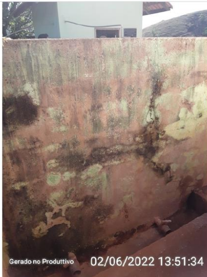
Infiltração na estrutura da ETA
