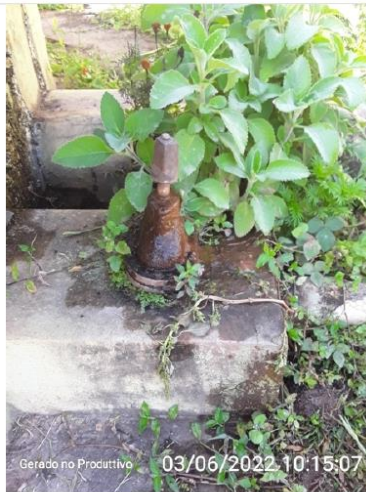
Vazamento no registro próximo aos floculadores
