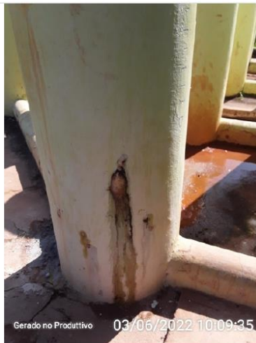
Infiltração nos floculadores
