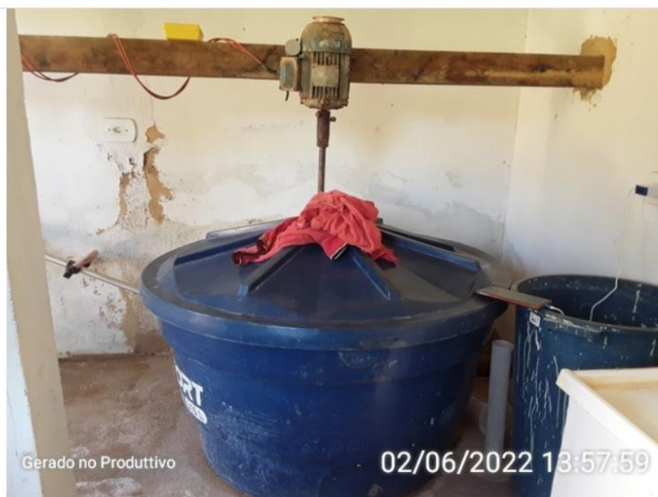
área de preparo e dosagem de produtos químicos
