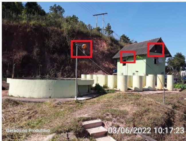
Iluminação na área da ETA
