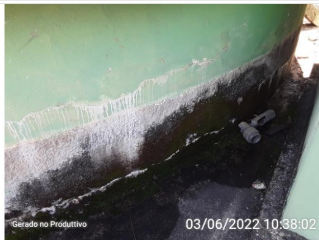
Infiltração na lateral do reservatório
