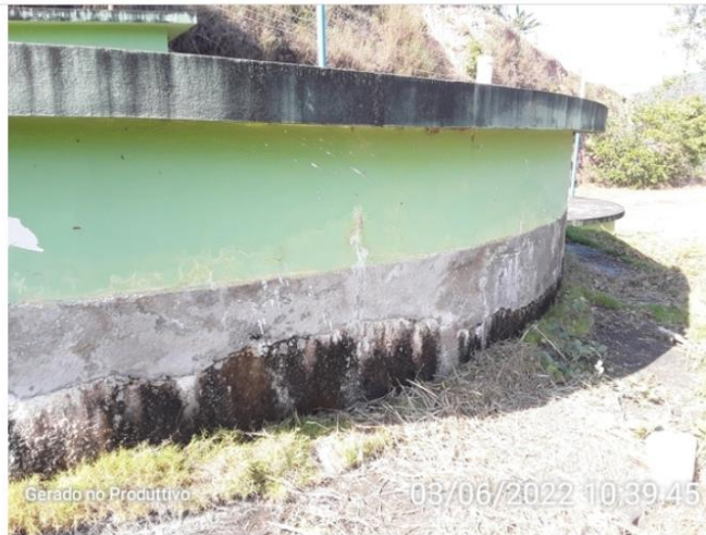
Infiltração na lateral do reservatório
