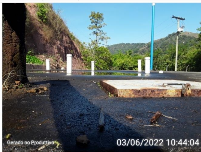
Tubulações de ventilação
