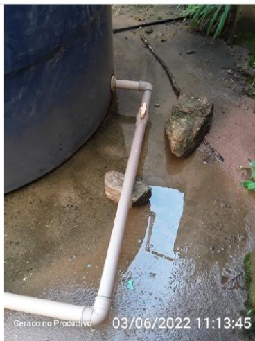
Válvula de fechamento na saída do reservatório
