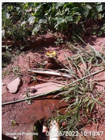
Vazamento no registro de descarga da adutora de água bruta
