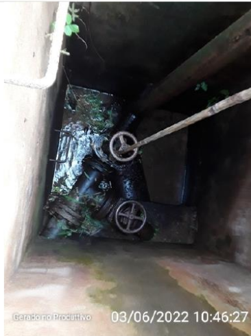
Tubo de descarga de fundo
