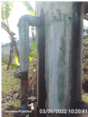
Infiltração na estrutura do filtro
