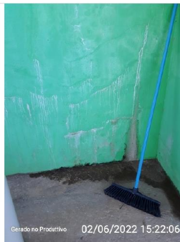
Infiltração na estrutura
