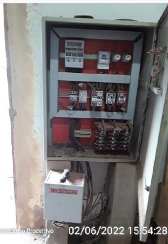
Quadro de comando
