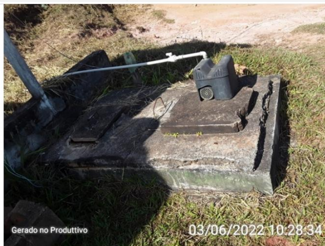
Caixa de passagem e local de dosagem do hipoclorito de cálcio
