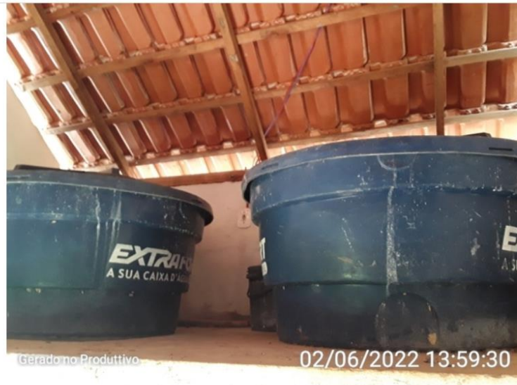
Reservatórios de produtos químicos
