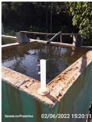
Primeira câmara de floculadores
