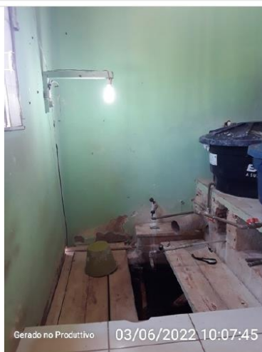
Área de dosagem do sulfato de alumínio
