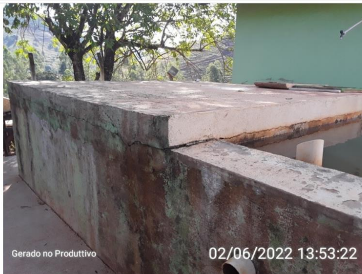
Tanque de contato
