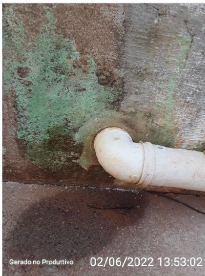
Vazamento próximo a tubulação
