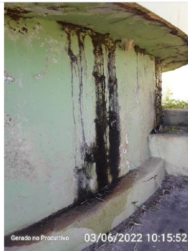
Infiltração no decantador
