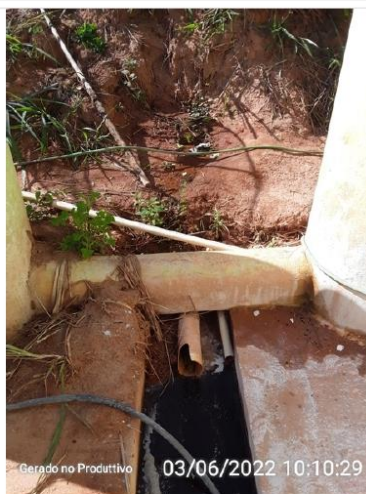
Descarga de água bruta
