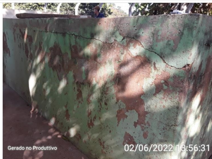
Rachaduras no tanque de contato
