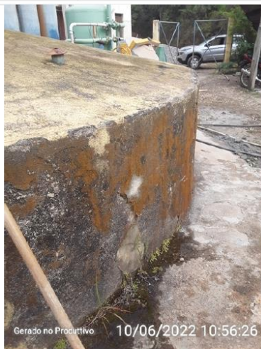
Patologias na estrutura
