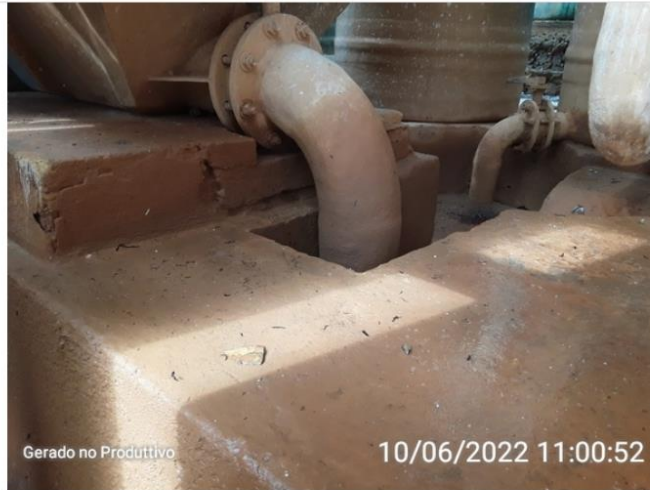
Tubos de descarga
