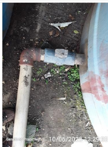
Válvula de fechamento na saída do reservatório
