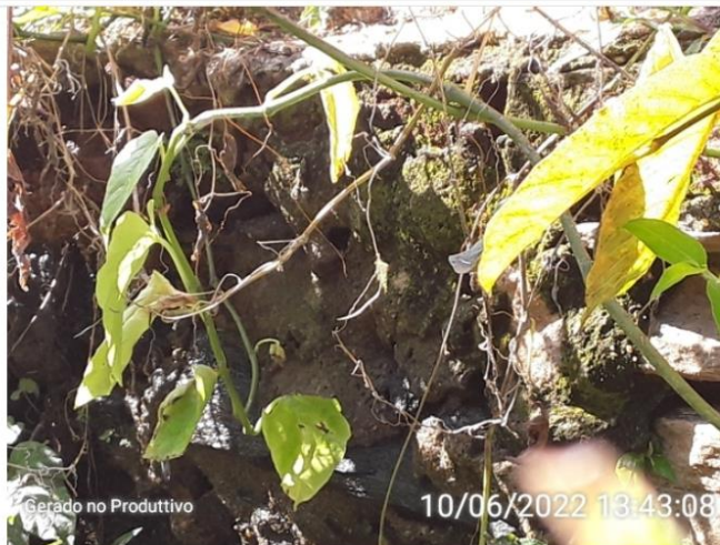
Vazamento na base do reservatório
