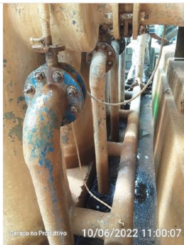
Descarga dos filtros
