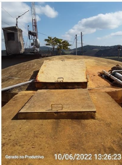
Tampas de inspeção
