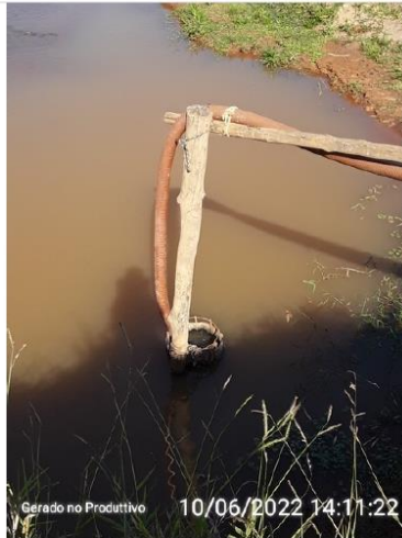
Grade da captação
