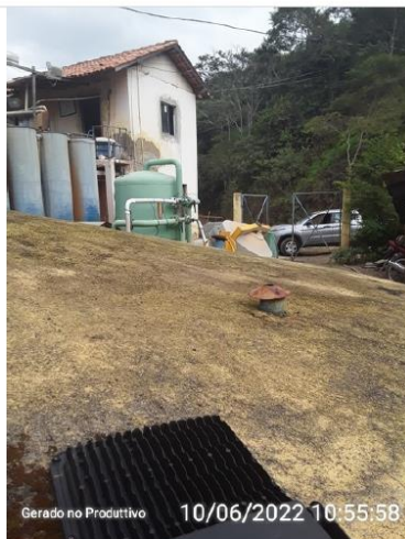
Tubulação de ventilação
