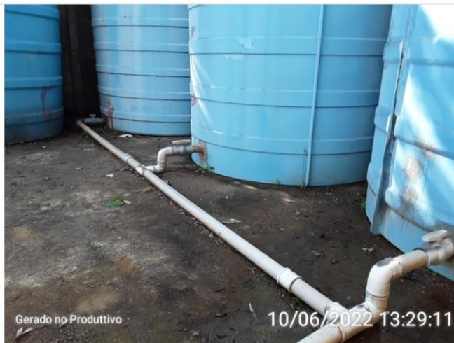
Válvula de fechamento na saída dos reservatórios
