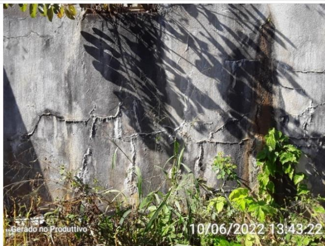
Patologias na estrutura
