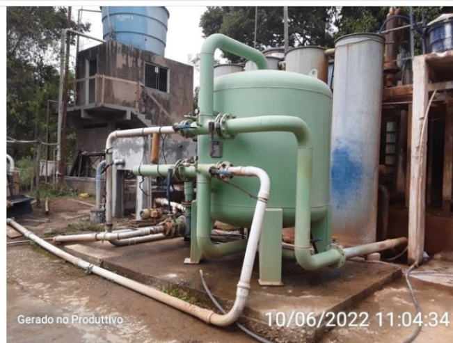
Filtro removedor de ferro
