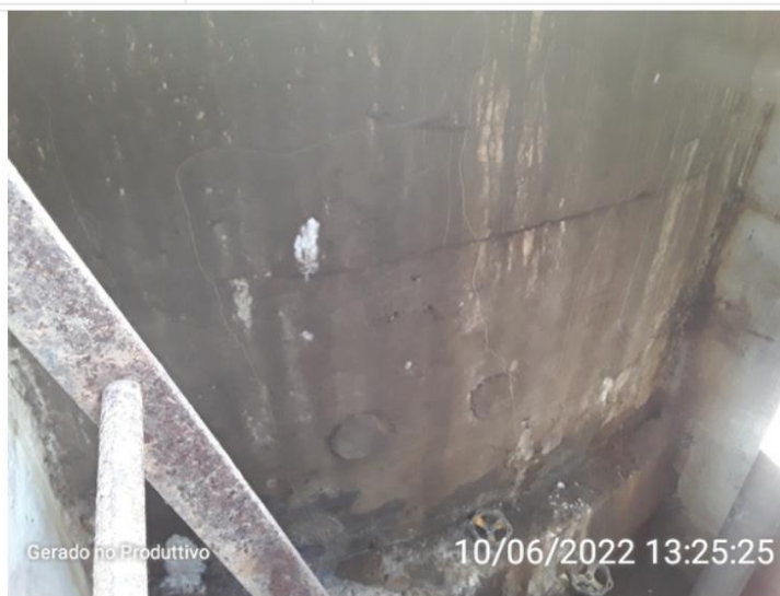
Interior da caixa de registros e lateral do reservatório
