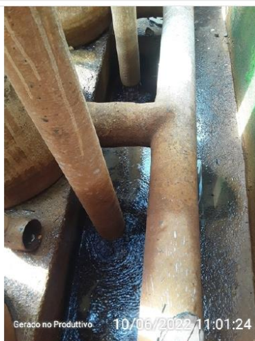
Vazamento na descarga dos filtros
