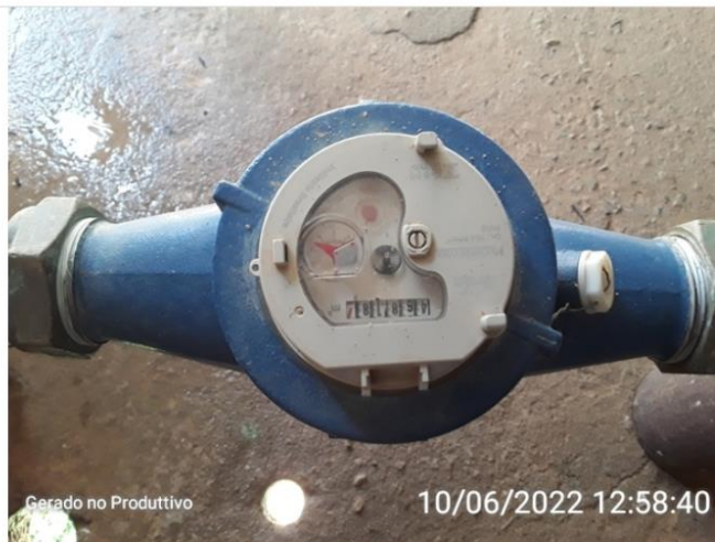
Dispositivo de controle de vazão
