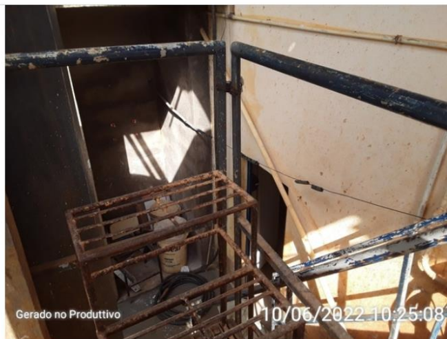
Escada para acesso a calha parshall
