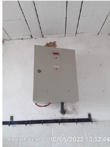
Quadro de controle
