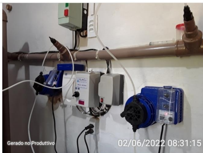
Bomba dosadora de produtos químicos.
