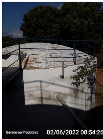
Tubo extravasor do reservatório.
