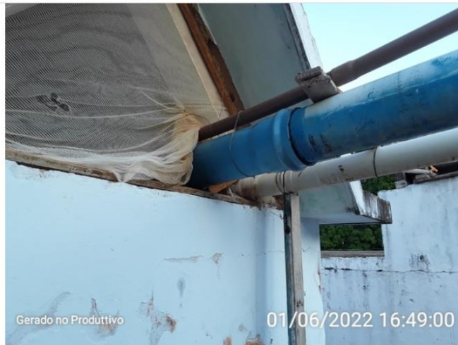
Tubulação de entrada do reservatório
