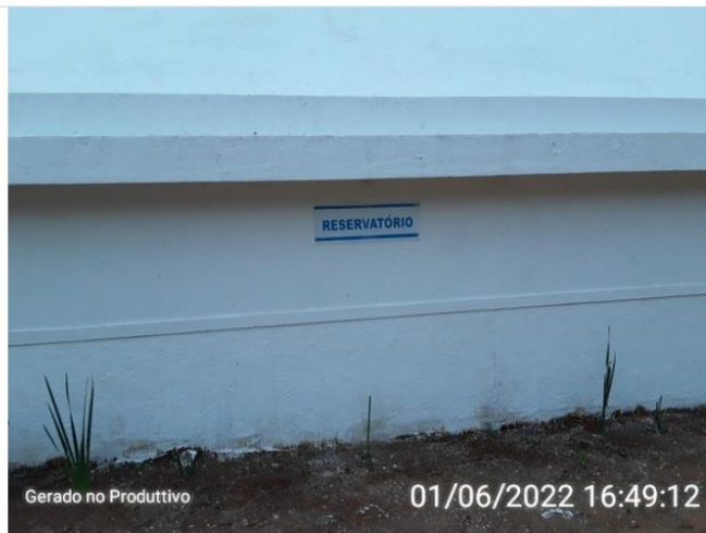
Placa de Identificação do Reservatório.
