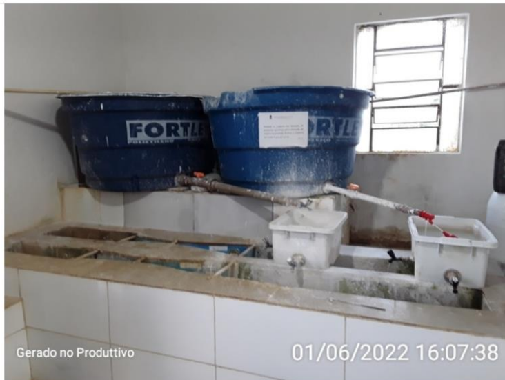
Área de preparo e dosagem do sulfato de alumínio e a cal necessitando de limpeza e acesso restrito.
