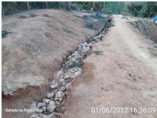
Drenagem da água que extravasa do reservatório elevado.
