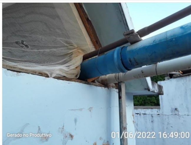
Tubulações chegando até o reservatório de contato com o desinfectante.
