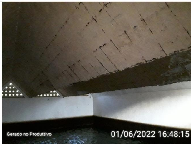
Estruturas internas em processo de oxidação.
