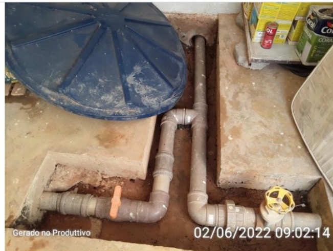
Válvulas de saída dos reservatórios parte interna do reservatório.
