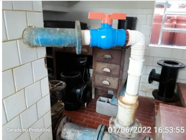
Tubulação de saída
