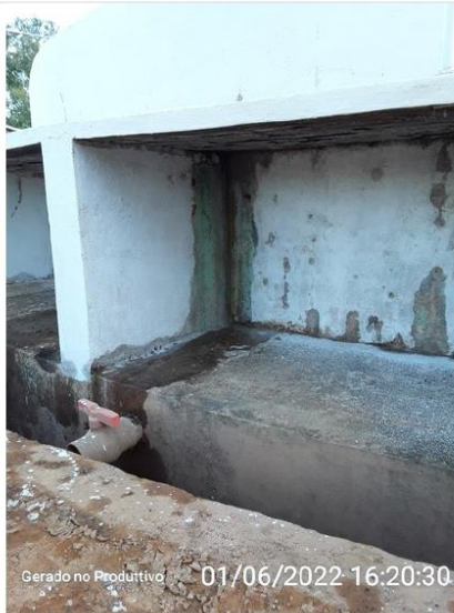
Patologias nas estruturas da ETA do sistema circular.
