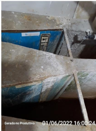
Réguas milimétricas de medição da vazão.
