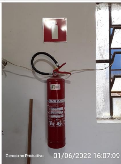
Extintor de incêndio.
