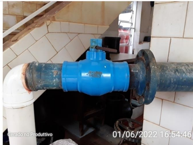
Tubulação de saída
