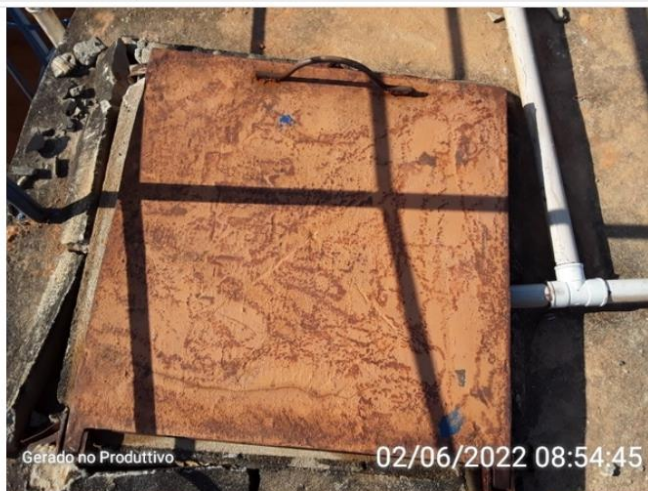
Tampa de inspeção sem cadeados.
