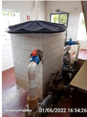
Tubulação de saída
