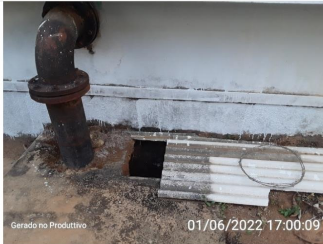
Tubo de descarga de fundo.
