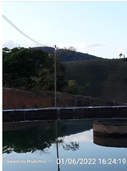
Postes de iluminação noturna nas estruturas da ETA.
