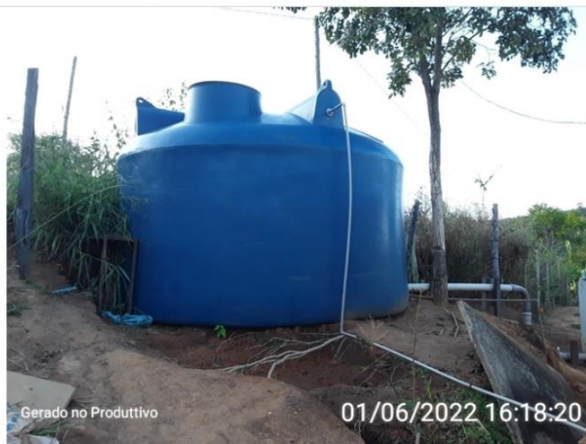
Reservatório Apoiado - PVC
