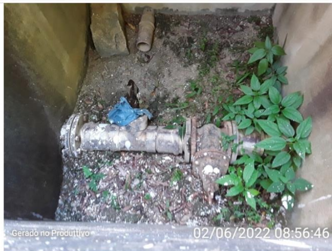
Válvula de fechamento na saída do reservatório sem registro.
