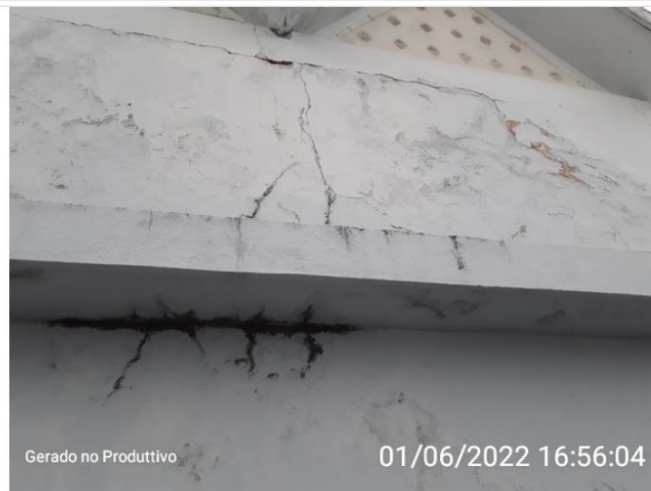
Estrutura com patologias.
