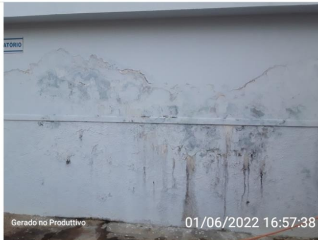
Infiltrações nas estruturas.
