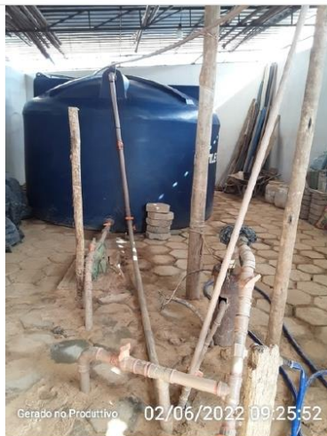
EEAT e Reservatório de sucção
