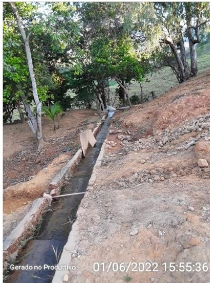
Canalização do excesso de água bruta que chega até a ETA para o curso d'água.
