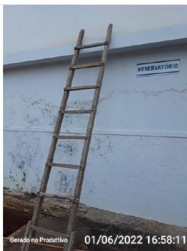
Escada para acesso
