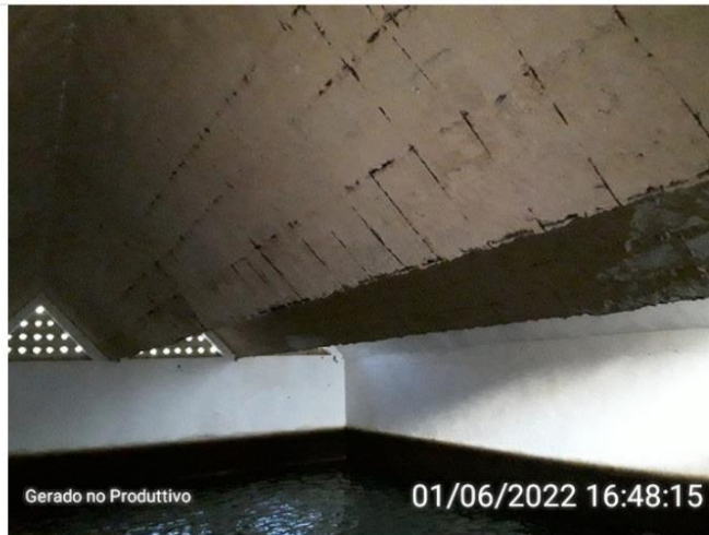
Cobertura do reservatório
