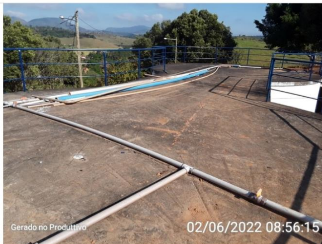
Vista superior do reservatório e ausência de dispositivos de ventilação.
