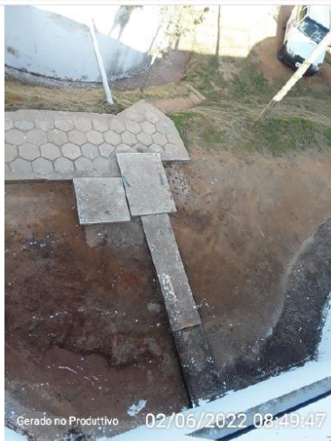
Local onde fica a válvula de fechamento da saída.
