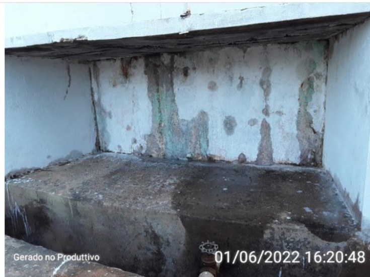
Infiltrações ETA Circular.
