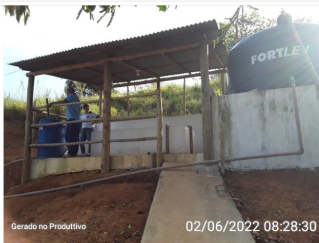
Local de chegada da água bruta e adição de cal.
