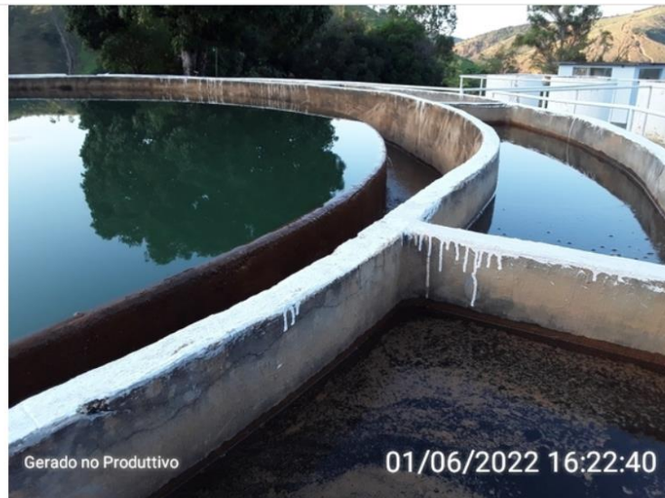
Formação de flocos nos floculadores circulares da ETA.
