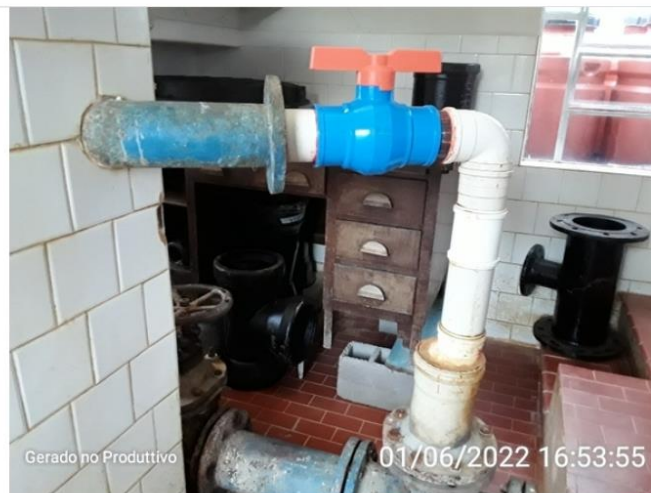
Válvulas de saída do reservatório para a distribuição na rede.
