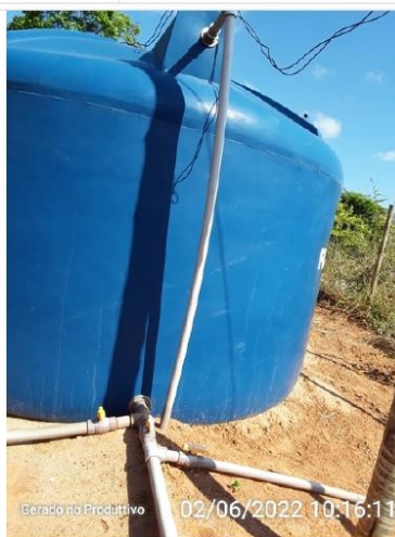
Válvulas de entrada e saída nos reservatórios.
