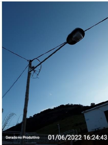
Iluminação nas estruturas da ETA.
