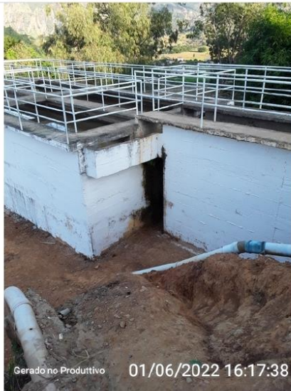
Estruturas retangulares com vazamentos e infiltrações.
