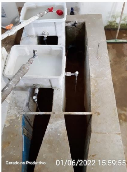
Calhas Parshal utilizada para medição de vazão.
