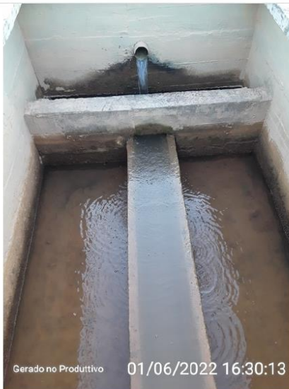
Filtro 1 do sistema retangular em boa condições.
