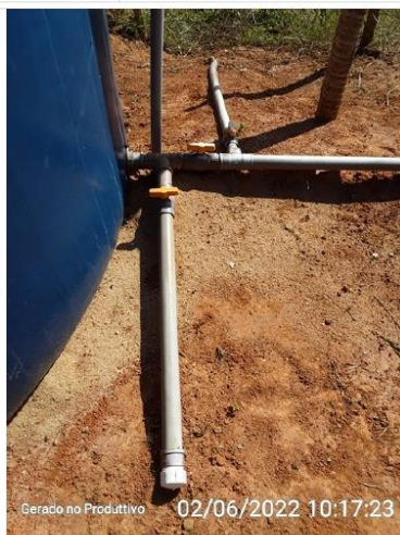
Tubo de descarga de fundo.
