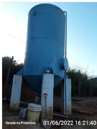
Reservatório Elevado - Metálico
