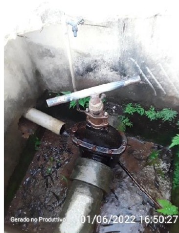
Válvula de saída do reservatório com vazamentos.
