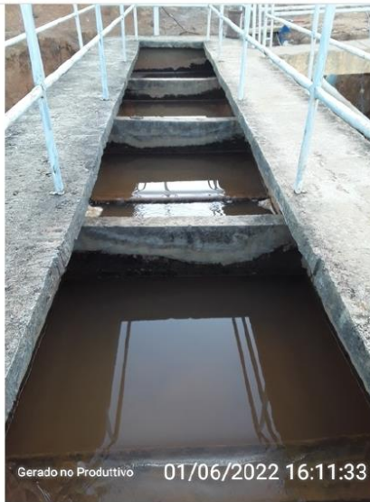
Filtros rápidos do sistema retangular da ETA em funcionamento.
