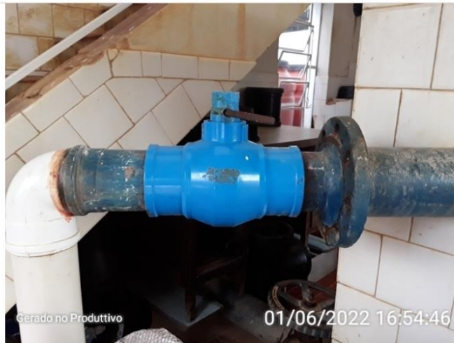
Válvulas com defeito na parte superior.
