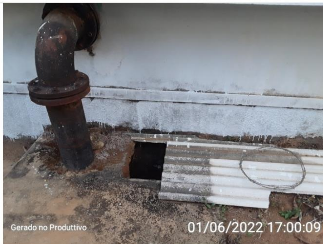
Caixa de descarga para o tubo extravasor
