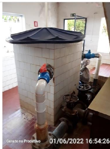
Válvulas de saída de água para a distribuição da rede.
