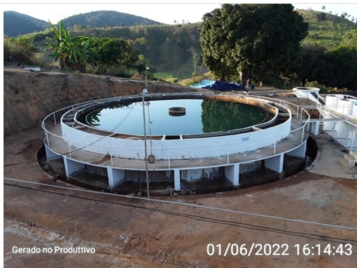
Decantador circular e floculadores do sistema circular da ETA.
