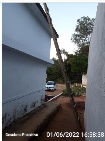
Escada para acesso
