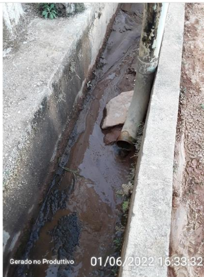
Vazamento de água tratada nas dependências da ETA.
