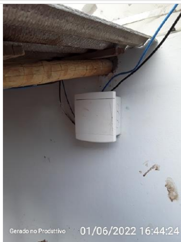
Disjuntor da ETA.
