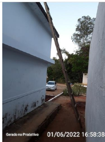
Escada sem guarda-corpo.
