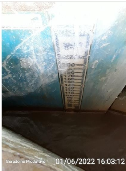
Régua medidora de vazão em bom estado de conservação.
