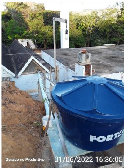
Iluminação no local de dosagem do desinfetante.
