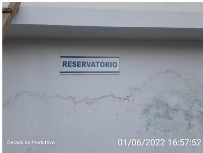
Patologia na estrutura do reservatório.
