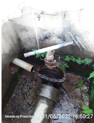
Válvula de saída do reservatório com vazamentos.
