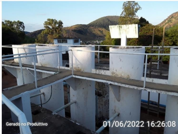
Filtros do sistema circular.
