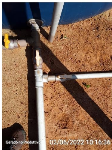
Vista superior das válvulas.
