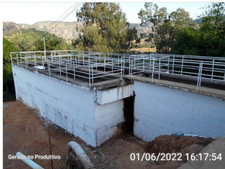
Decantadores e Floculadores do sistema retangular.
