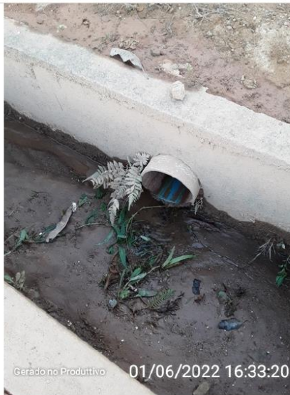
Perda de água tratada.
