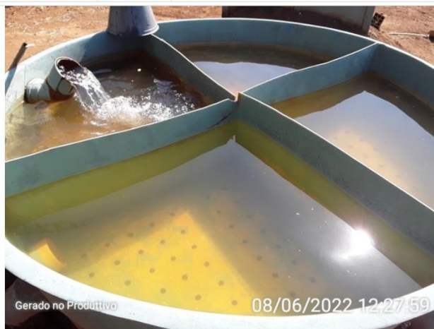
Floculador da ETA.
