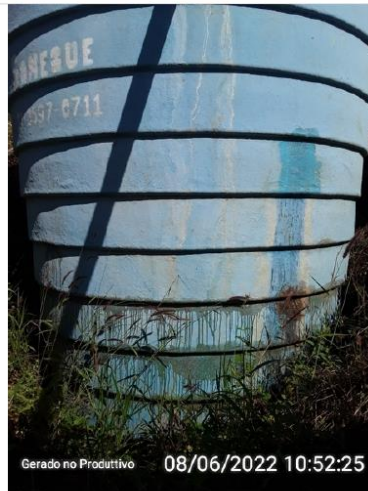
Vazamentos nas estruturas dos reservatórios.
