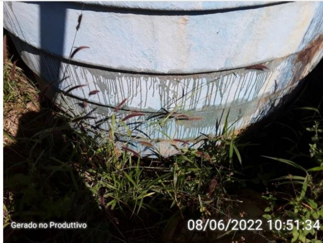
Vazamento na parte inferior
