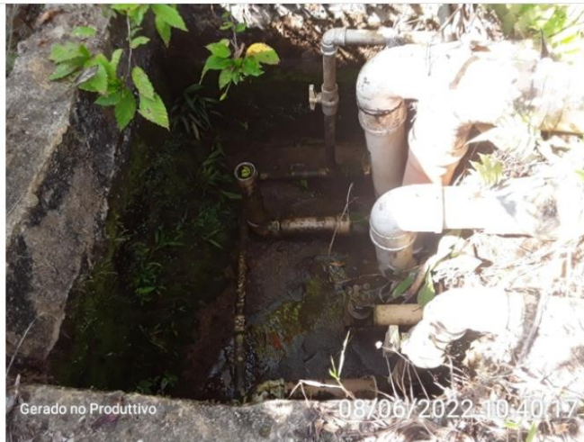
Descarga de fundo dos reservatórios apresentando vazamentos aparentes.
