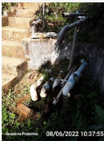
Descarga de fundo dos reservatórios.
