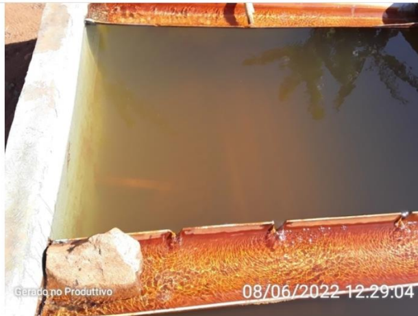
Decantador da ETA.
