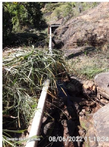
Adutora de captação de água bruta.
