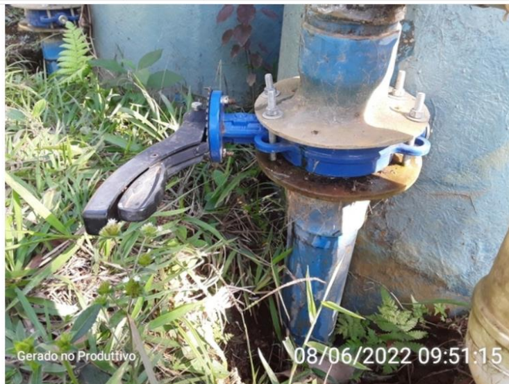
Válvulas com vazamento.
