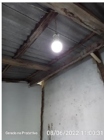
Iluminação na casa de bombas
