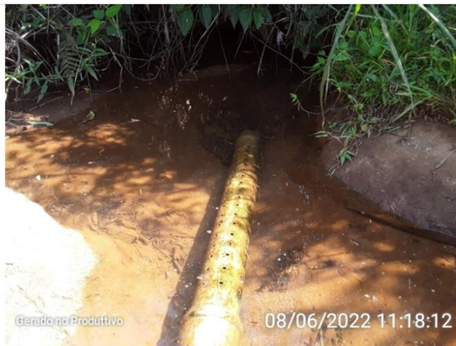
Tubos de PVC perfurado para captação de água bruta.
