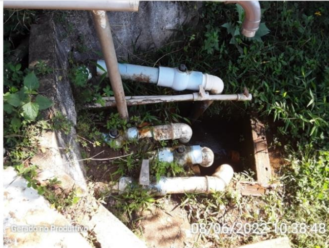
Descarga para limpeza dos filtros
