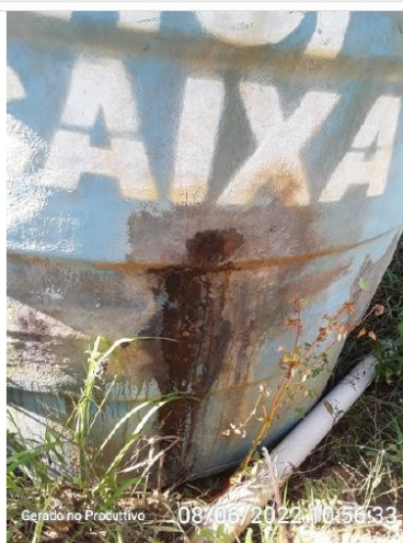
Estruturas dos reservatórios com infiltrações.
