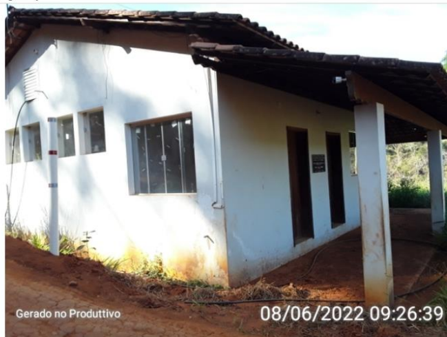
Área administrativa e laboratório da ETE
