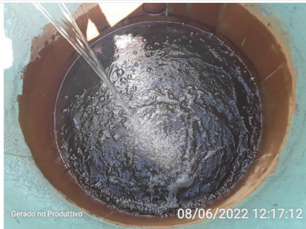
Entrada de água no filtro inadequada.
