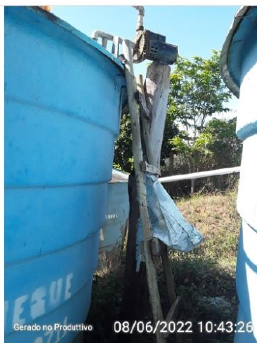
Bomba para lavar os filtros
