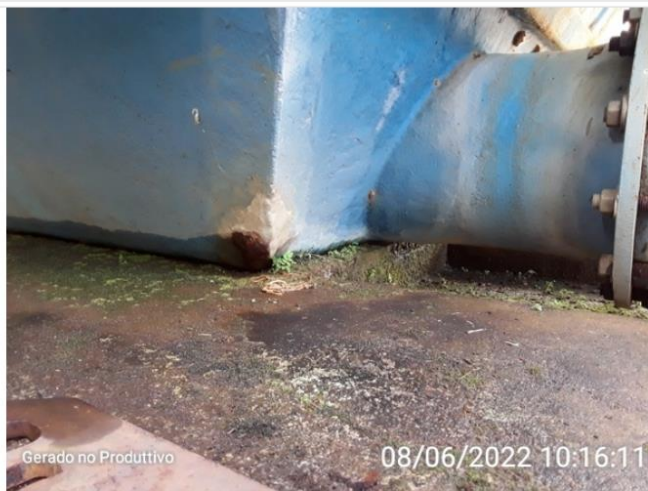
Vazamento na estrutura da ETA
