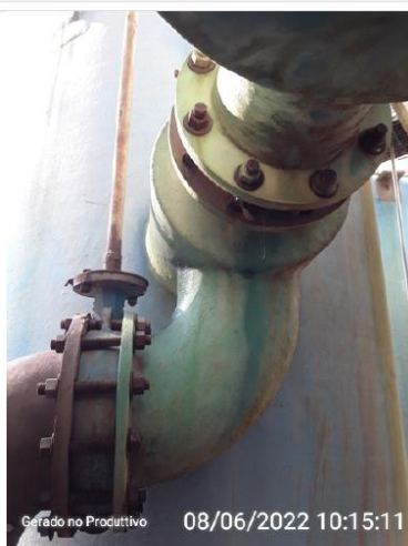
Vazamento no registro
