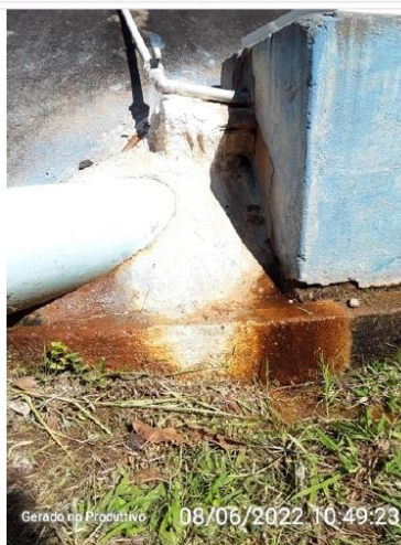
Vazamento no reservatório
