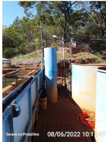
Sistema de iluminação
