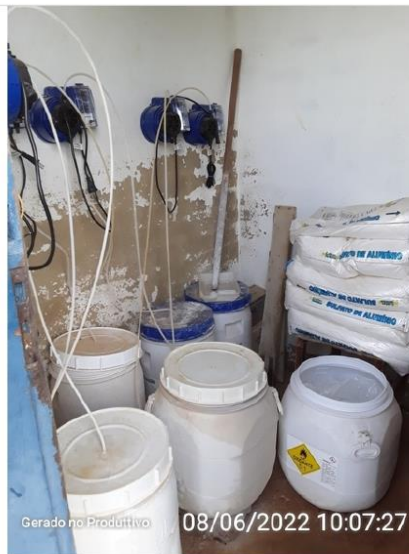
Bomba Dosadora de Cloro
