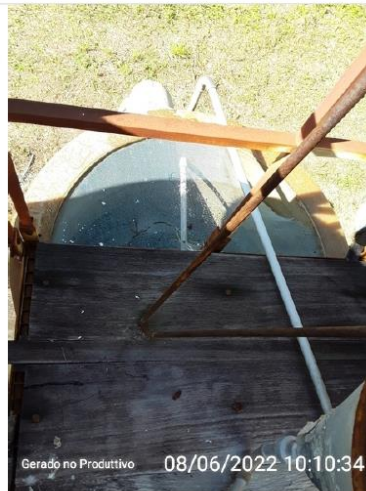
Local da dosagem do flúor
