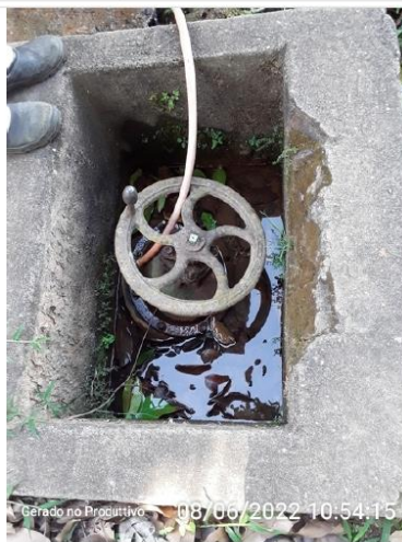
Válvula na saída do reservatório
