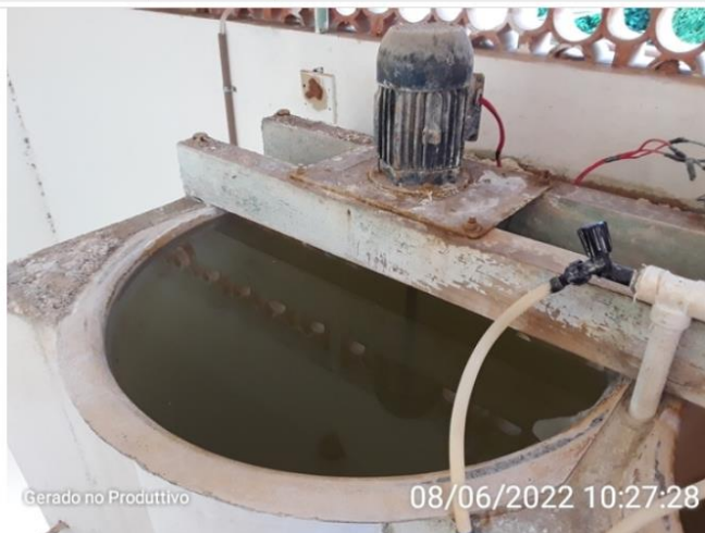
Tanque de preparo de produtos químicos
