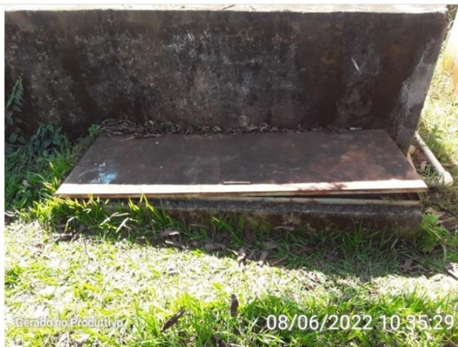
Caixa de válvulas.
