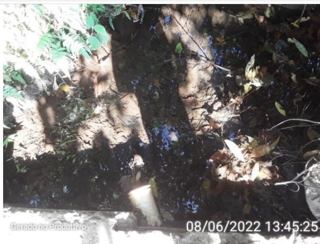
Tubo de captação sem gradeamento ou telas.
