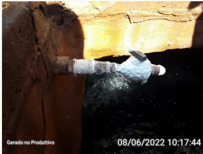
Local de dosagem do cloro
