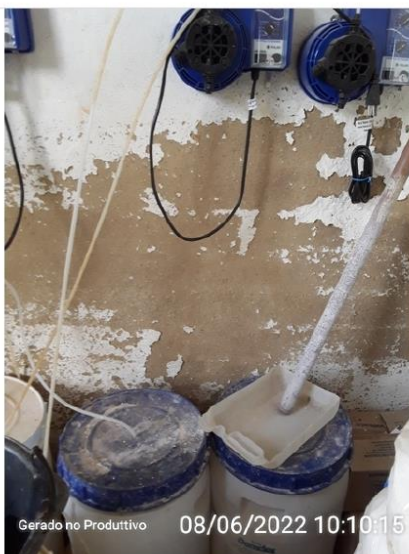
Bomba dosadora de Cloro.
