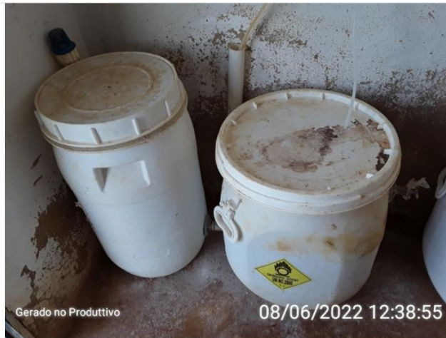
Gerado no Produttivo 08/06/2022 12:38:55 Bombonas plásticas usadas na dosagem.
