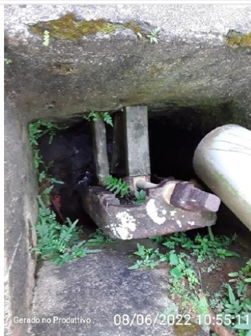
Tubo de descarga de fundo
