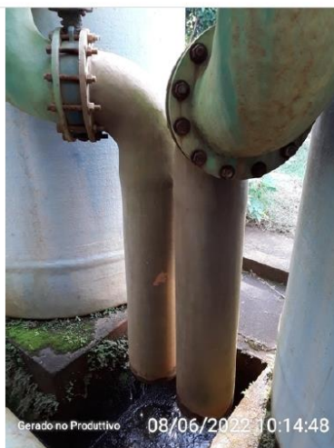
Vazamento nos registros
