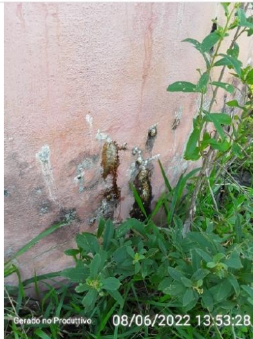
Patologia na estrutura do reservatório
