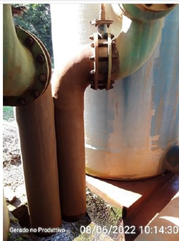
Vazamento nos registros
