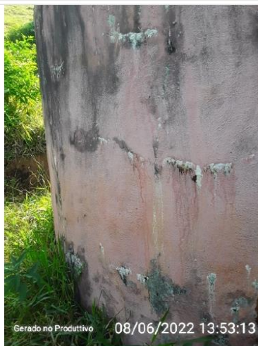
Patologia na estrutura do reservatório
