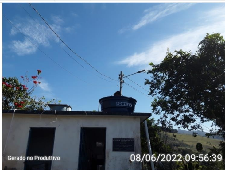
Iluminação na ETA.
