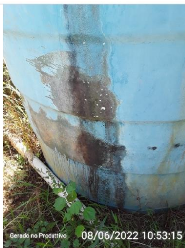
Reservatório com infiltração.
