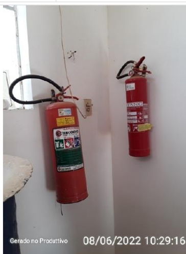
Extintores de incêndio
