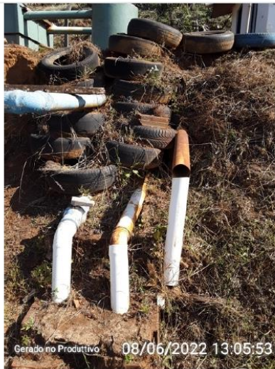
Descarga de limpeza do decantador
