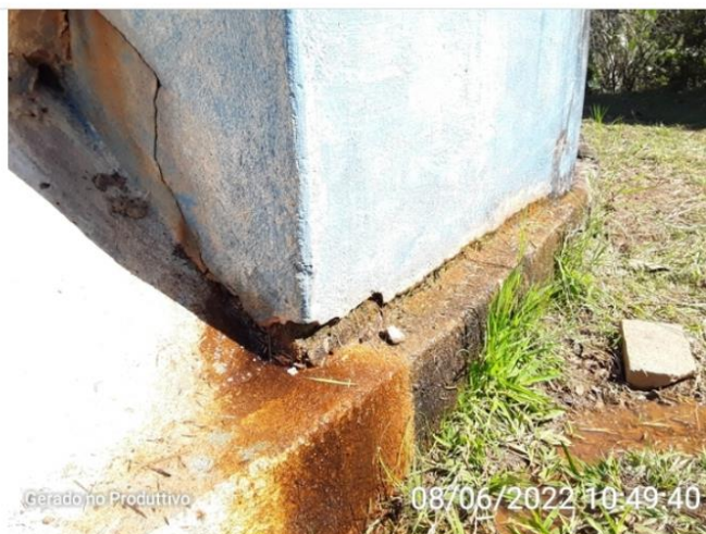
Vazamento no reservatório
