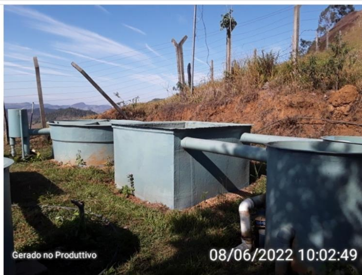
Sistema B, em funcionamento.
