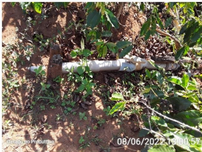
Válvula de saída dos reservatórios.
