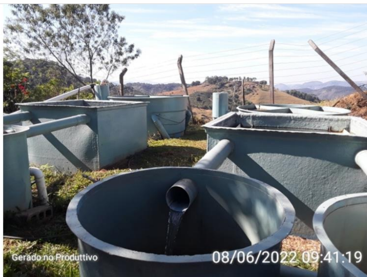
Estruturas da ETA com os dois sistemas.
