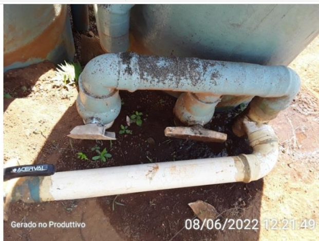
Vazamento na estrutura dos decantadores.
