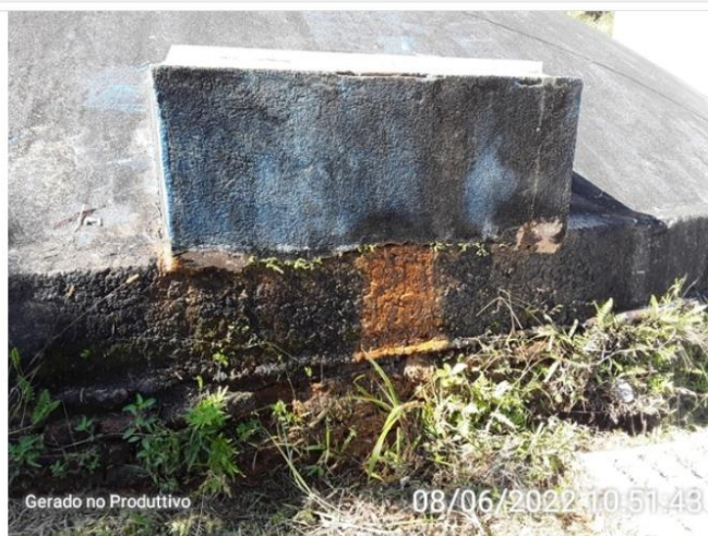
Vazamento no reservatório
