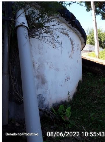
Patologias da estrutura
