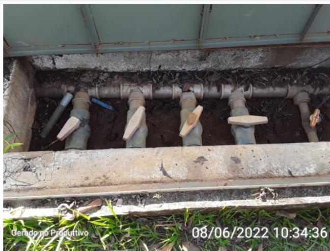
Válvulas usadas como tubo extravasor
