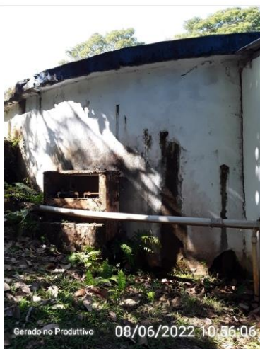
Patologias da estrutura
