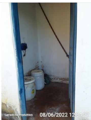
O Depósito e casa de químicos são no mesmo compartimento.
