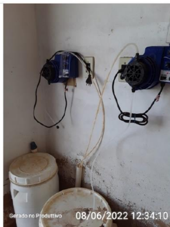
Bomba Dosadora de Cloro.
